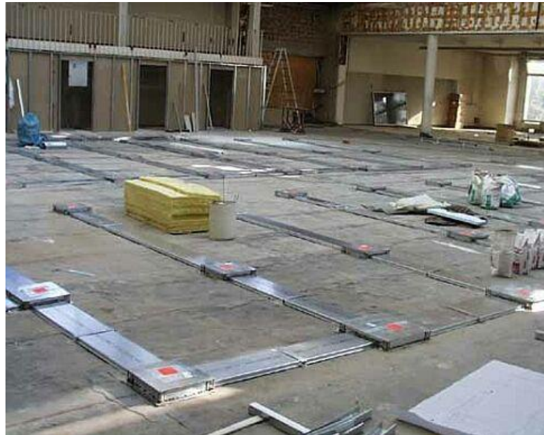
Kabelkanäle im Lesesaal der Universitätsbibliothek der FU Berlin
