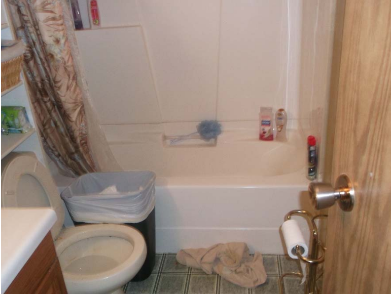
Tight bathrooms with no space to expand disabled access. / Petites salles de bains sans espace pour améliorer l'accès pour les personnes handicapés.
