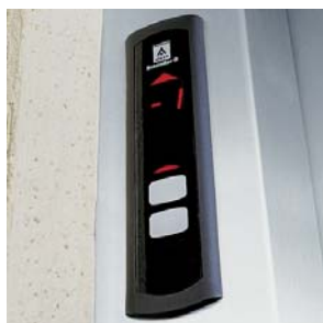
▲ Botoeira de pavimento piso principal
