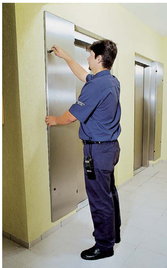
▼ Painel de controle eletrônico no hall do último pavimento
