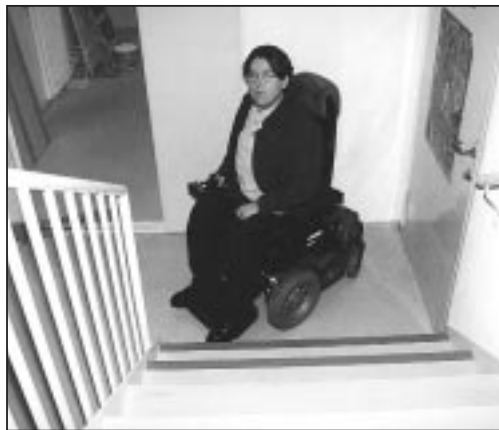
Amanuensisvikar Atle Møen har to like umulige valg for å komme seg inn på podiet når han skal forelese i Stort Aud. på SV-bygget; enten ned en lang trapp inne i auditoriet, eller bakveien opp denne bratte trappen.
