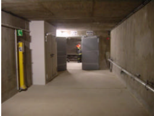
Abbildung 4: Schleuse zwischen Rettungsschacht und Fahrtunnel
