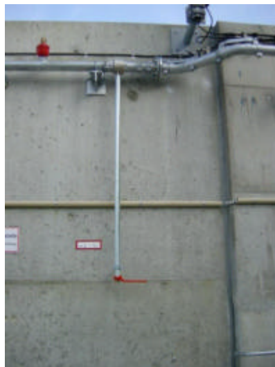
Abbildung 16: Absperrschieber in Trockenleitung
