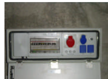
Abbildung 14: Elektrant im Tunnel
