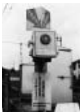
支障報知装置 （非常ボタン）
