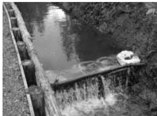
上流部の用水路 (2001/03/02) 割石の量が不足し、上流部では木材と土壌による堰堤を構築した。これは簡単に崩壊した。
