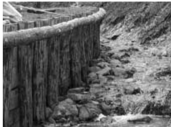
マツ杭と板による用水路 石が投入されているが、量的に不足している。 (2001/02/10)
