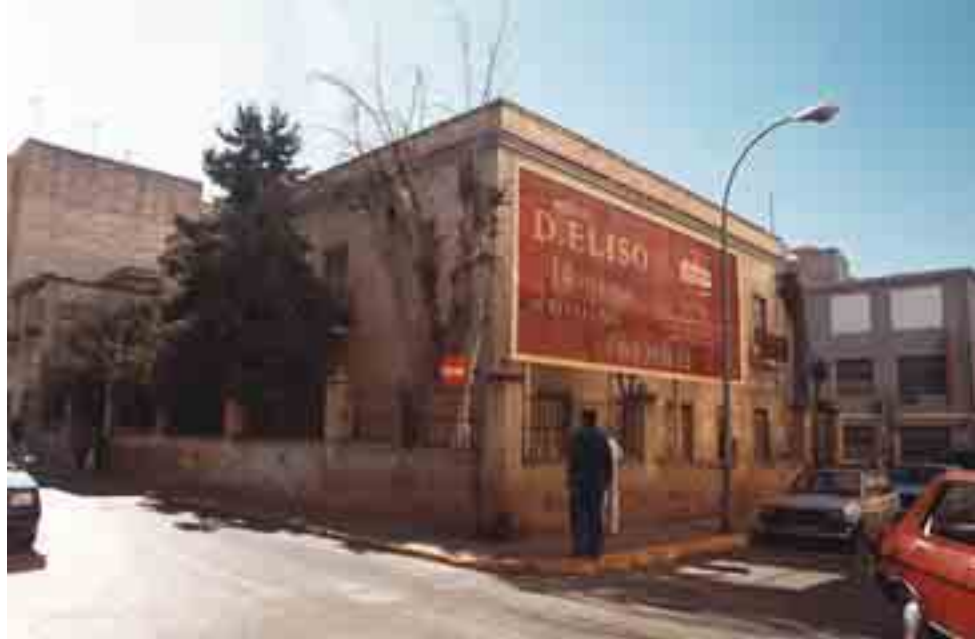
El edificio de la conocida academia de D. Eliso poco antes y durante el derribo, para dar lugar al edificio de viviendas del mismo nombre. 1999.
