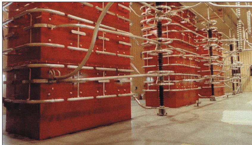
Fig. 4 - Sala valvole dell'impianto SACOI 2
