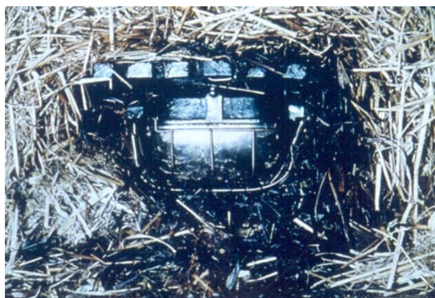
Bild 4 Brandgefahr: unzureichender Sicherheitsabstand einer Leuchte zu brennbaren Materialien
