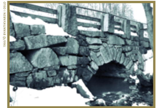
KALBAKKBRUA FRA CA. 1790 ER EN AV LANDETS ELDSTE STEINHVELVBRUER. BRUA ER FREDET.
