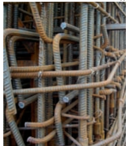
Die Bewehrung ist ausgesprochen dicht
