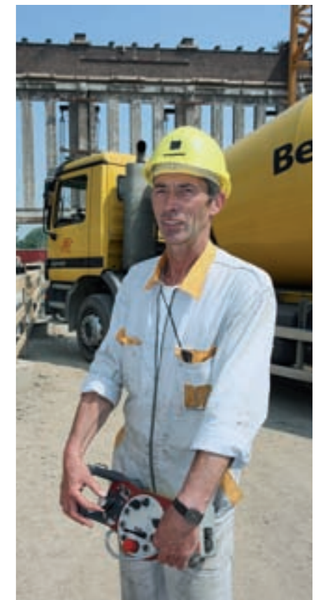
Konzentriert steuert Pumpenfahrer Joachim Böhme den Verteilermast seines M 62-6 über die Schalung
