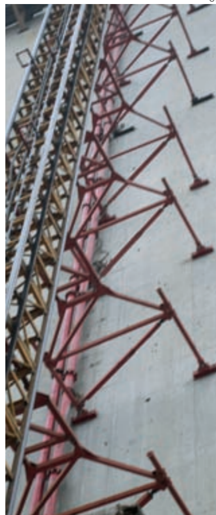
Die Hochdruck-Betonförderleitung ist an der Außenwand der über 300 m hohen Pylone befestigt
