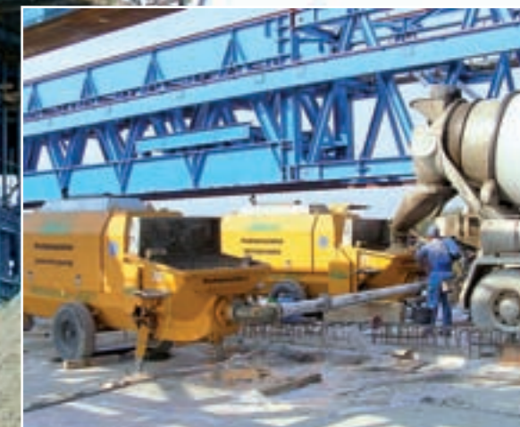
Die 150 m langen Förderleitungen sind gegen Hitze und Kälte gut isoliert
