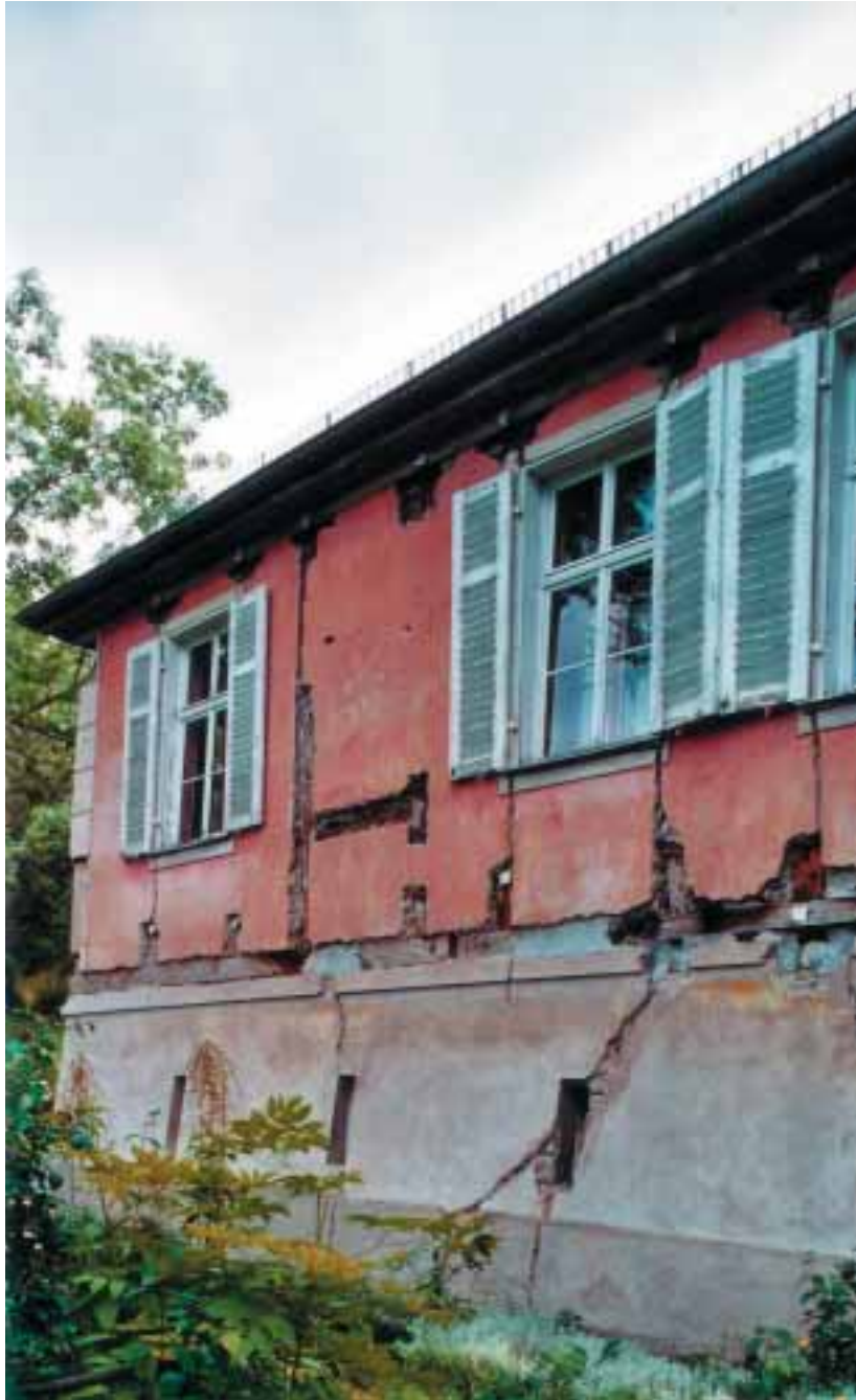
ABB. 16 Pogwischhaus, Westfassade nach den holzschutz- technischen Unter- suchungen des Fachwerkes
