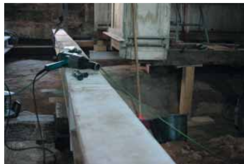
ABB. 5 Herzogin Anna Amalia Bibliothek, Stahlträger vor dem Einbau unter den Stützen der Saalkonstruktion
