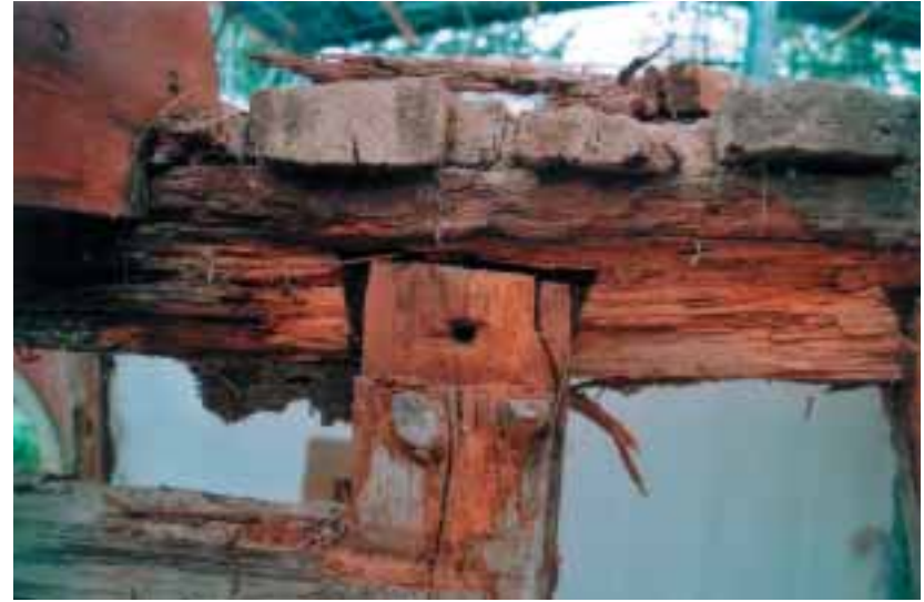
ABB. 17 Pogwischhaus, Extreme Holzschä- den am Fachwerk
