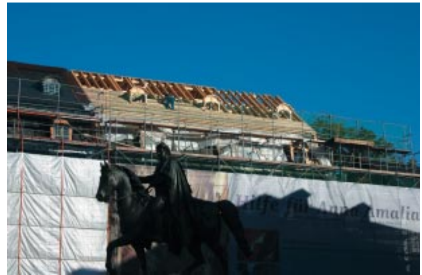
ABB. 11 Herzogin Anna Amalia Bibliothek, Wiederaufbau des durch den Brand zerstörten Daches über dem Rokokosaal
