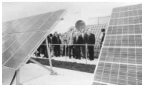
Photovoltaik-Anlage auf dem Dach der Gewerblichen Kreisberufs- und Fachschule Neckarsulm
