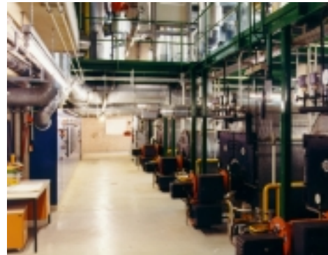
... reihen sich in die vier bestehenden Kessel im Kreiskrankenhaus Plattenwald ein
