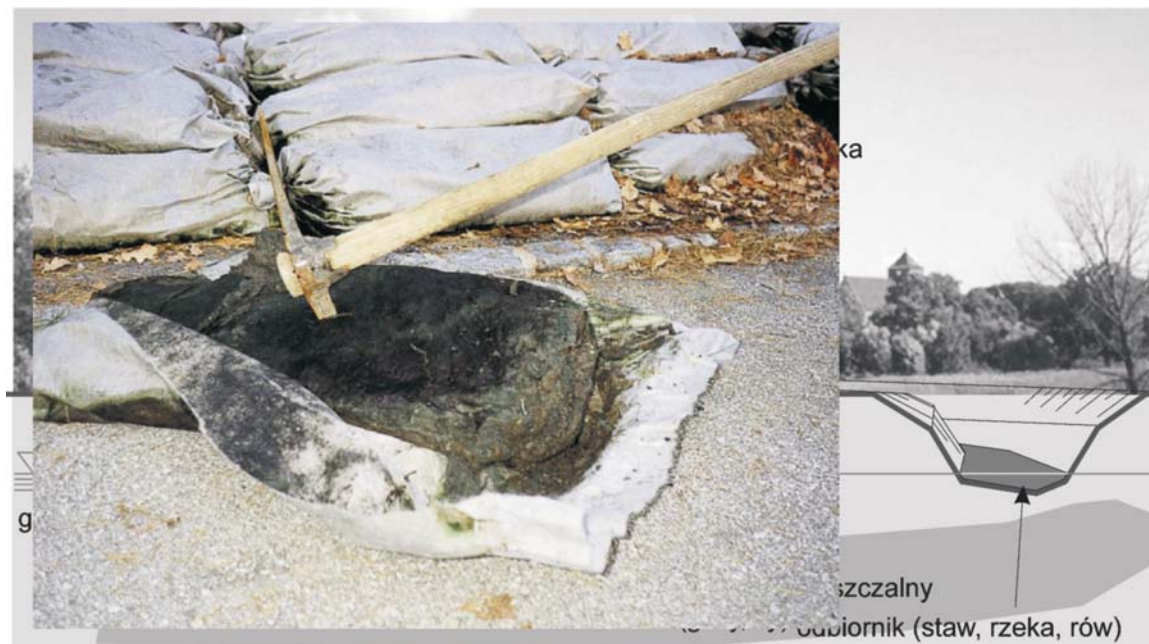
Rys. 29 Osad po odwodnieniu w oczyszczalni ścieków
