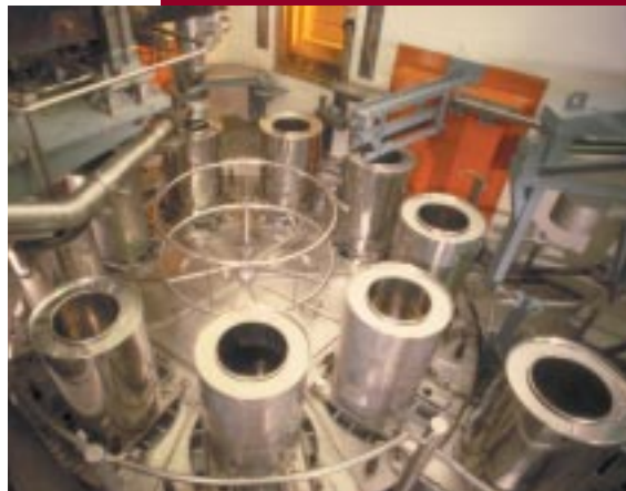
Station de traitement des effluents STE3 Carroussel d'enfûtage COGEMA La Hague
