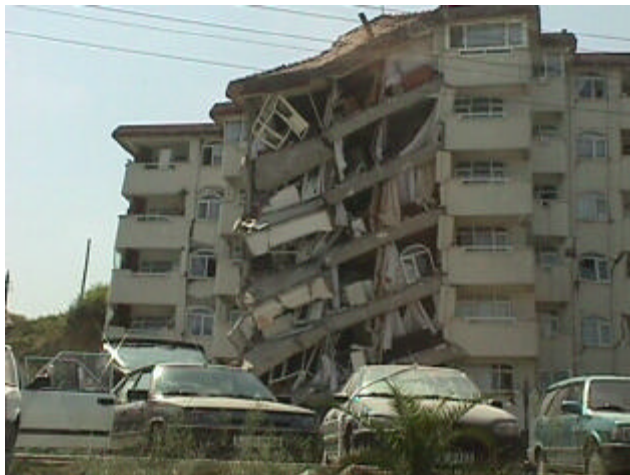
Abb.1.1.5 Eingestürztes Wohnhaus nach dem Erdbeben in Izmit / Türkei, 17.08.1999, M_w=7.4 , (USGS NEIC; http://neic.usgs.gov/neis/bulletin/99_EVEN_TS/990817000138/ )
