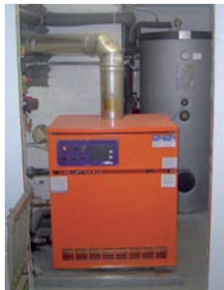
Ketel met een vermogen van 75 kW en opslag van 500 liter SWW
