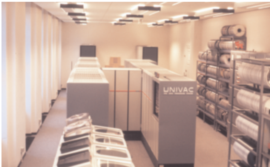
Maskinstuen set i retning mod Fælledparken. I forgrunden ses pladelager, og i baggrunden den centrale datamaskine. De hurtige tromler og FASTRAND-tromlen er anbragt i kælderen under maskinstuen.
