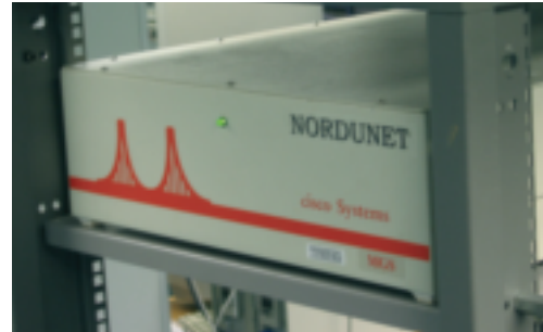
Danmarks første router, en Cisco MGS.
