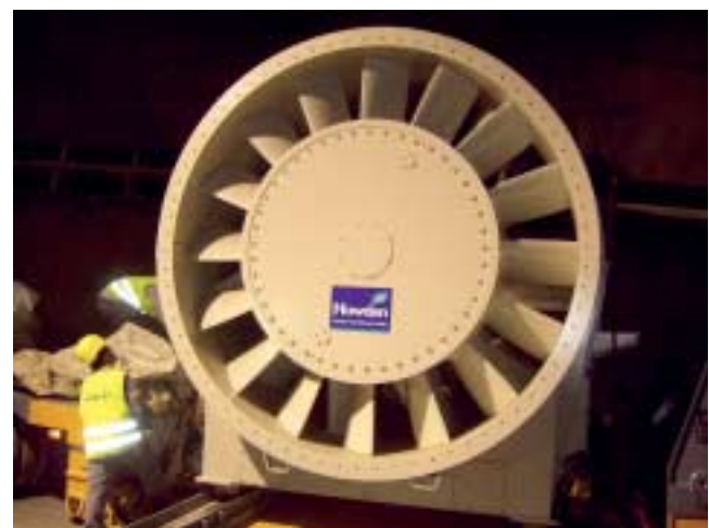
10 Ventilator in der Lüftungszentrale Fystertellä; Leistung 250 m 3 /s
