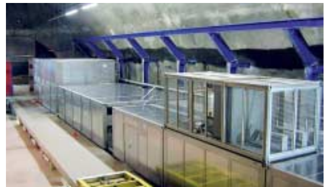
9 Container in der Betriebszentrale Lötschen Ost
