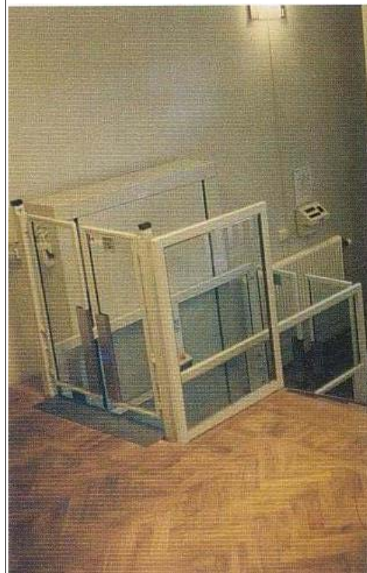
Figur 4.10 Den nye, innvendige heisen som tar opp nivåforskjellen.
