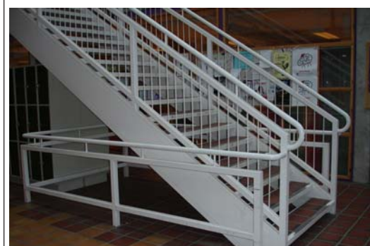
Figur 5.10 Rekkverk rundt trapper er laget slik at man ikke skal gå på trappa og slå seg i hodet.
