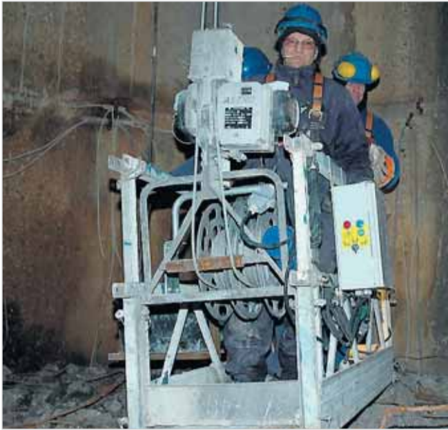
Bent og sjakket er klar til endnu en tur op i 106 meters højde. Arbejdet med at rive skorstenen ned forventes afsluttet i løbet af et par uger. Fra cirka 40 meters højde overtager maskiner arbejdet.
