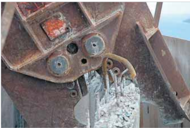
Saksen her klipper betonen i stykker. Betonen skal senere sorteres fra armeringsjernet.
