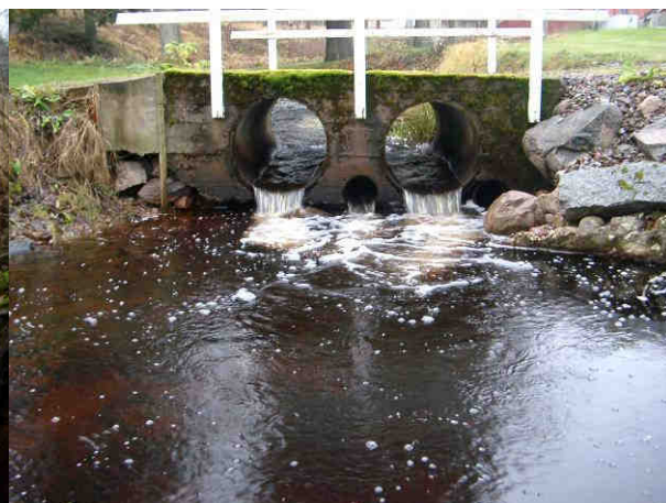
Foto 3. Vid Östfora finns ett tydligt exempel på hur fel lagda vägtrummor kan hindra fiskvandringar.
