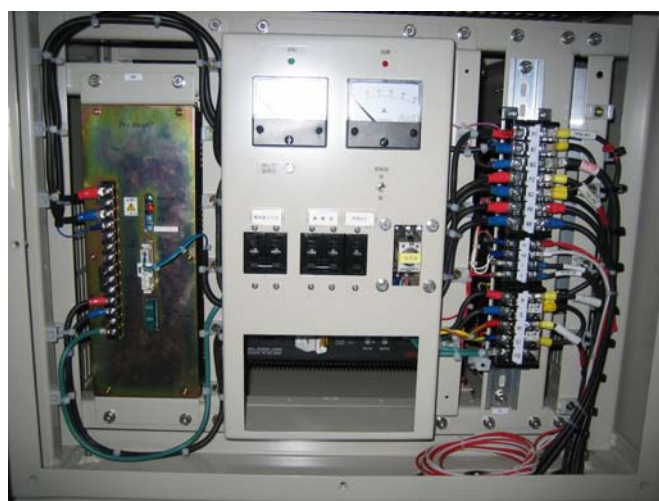
図5 直流電源装置外観
