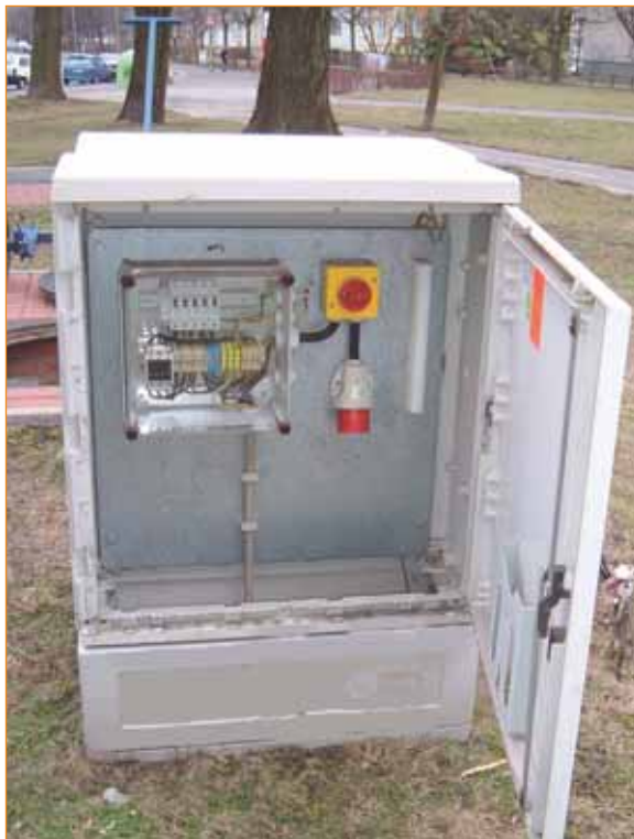
Bild 3. Stromeinspeisung außerhalb des Schachtes
