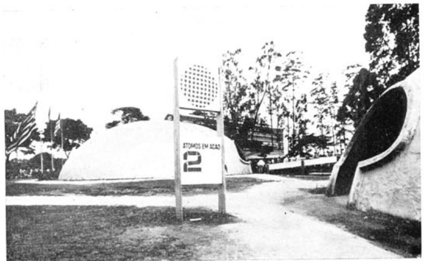
Atomic Energy Commission: realizzazione del Centro Dimostrativo Nucleare a San Paolo (Brasile) in n. 3 cupole da 25 m di diametro. (tempo di realizzazione: 1 mese)
