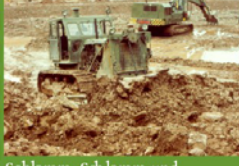
Schlamm, Schlamm und nochmals Schlamm ...
