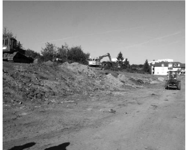
Die Bauarbeiten haben begonnen: Blick zur Böschung der Kleingartenanlage, im Hintergrund die Häuser Struthbachweg. Die Bäume wurden gefällt und die Böschung wird abgebaggert, um Platz für die Spielflächen zu gewinnen.
