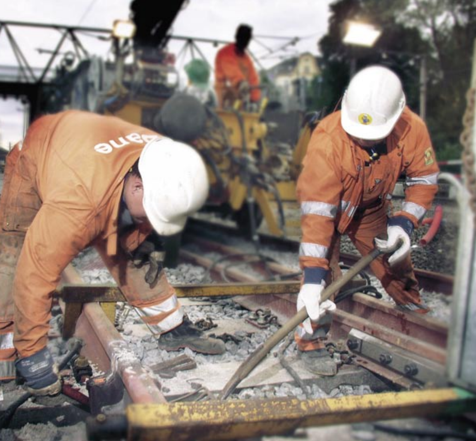
travel sommer med å reparere nedslitte spor... Inmfelt: Jernene som skal holde todelte betongsviller på plass, er rustet av.
