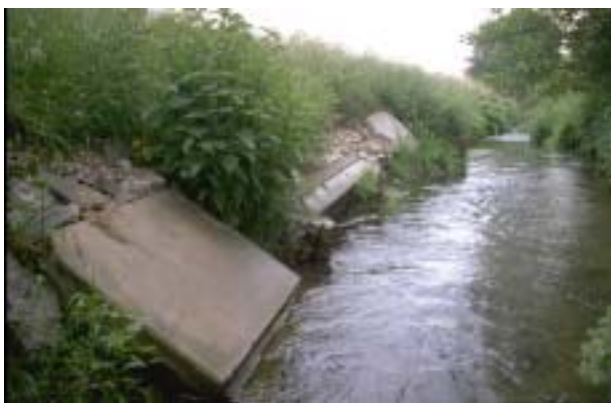
Ufersicherungen aus "Bauschutt" (oberhalb Bollodingen) sind an recht vielen Stellen der Önz zu finden und sind weder schön noch sinnvoll, sie sind verboten!
