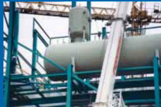
Savonlinnan voimalaitoksen syöttövesisäiliö.
