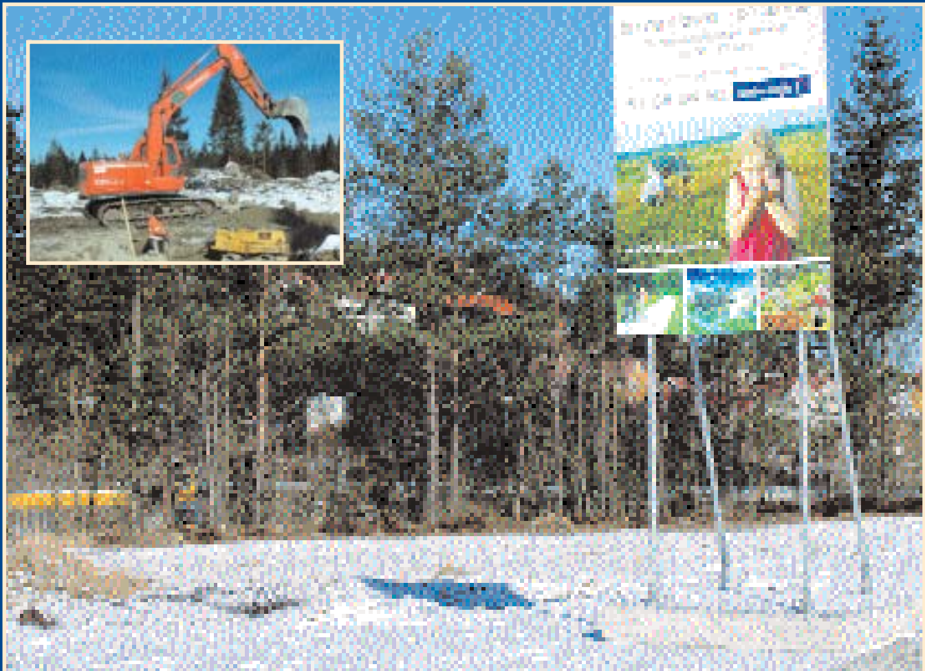
Grunnarbeidene har nå startet opp for første byggetrinn av Blåbærhagen på Bogafjell.
