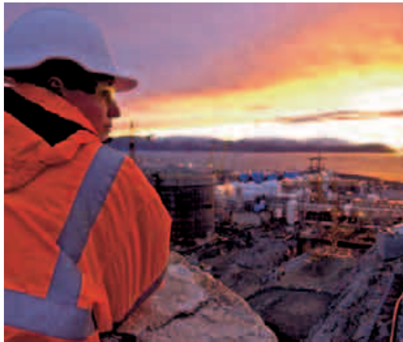
Wasserfest und windgeschützt: Rund neun Millionen Stunden werden die Menschen auf Melkøya gearbeitet haben, bis die Anlage 2007 in Betrieb geht.
