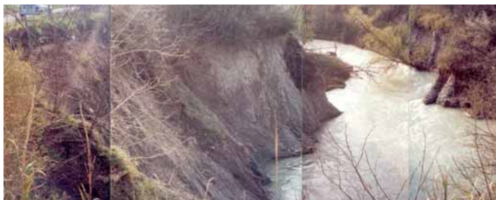
Fig.6 – Approfondimento dell'erosione in alveo ed erosione di sponda lungo il fiume Chienti
