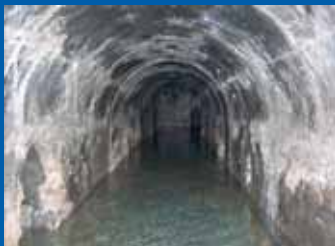
Sorg. Capodacqua: interno di una delle gallerie di captazione
