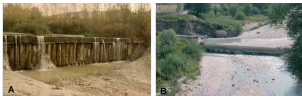
Fig.3 – Evidenti fenomeni di scalzamento al piede: a) briglia nel fiume Tenna; b) traversa nel fiume Chienti.
