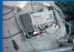
Datalogger per l'acquisizione dei dati di temperatura, conducibilità elettrica e livello idrostatico
