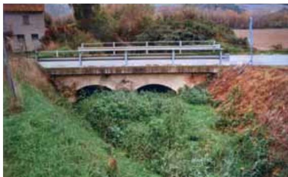
Fig.4 – Assenza di manutenzione lungo il reticolo idrografico minore
