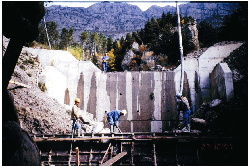
Construction d'un barrage sur le torrent du Bramafan, commune du Castellard-Melan – 27 octobre 1997
