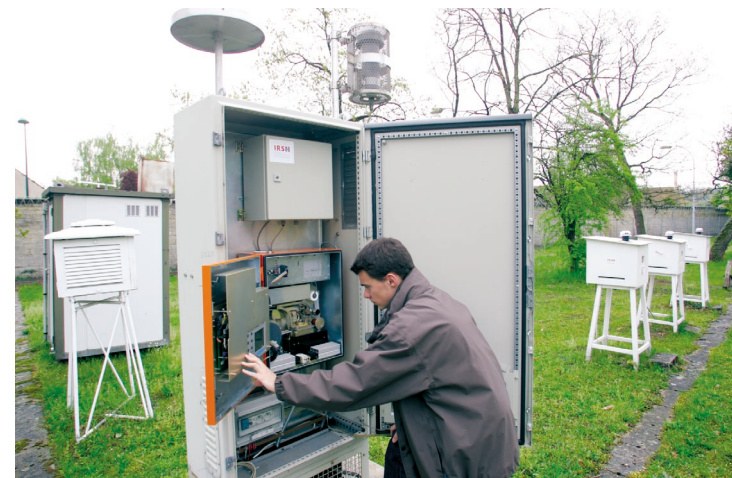
Intérieur d'une balise SARA (surveillance des aérosols).
