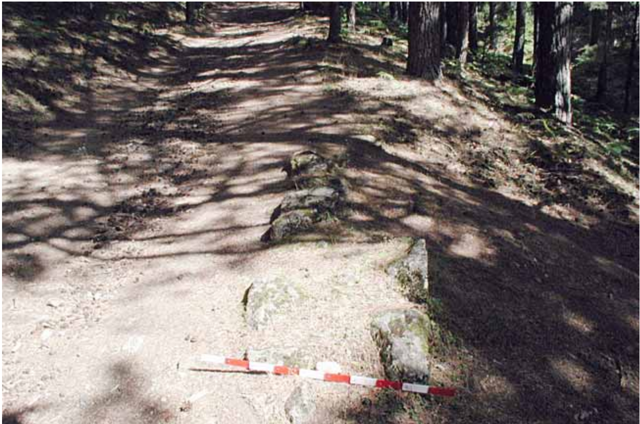
Ilustración 1: El muro de contención en el lado derecho del Camino Viejo a Segovia
