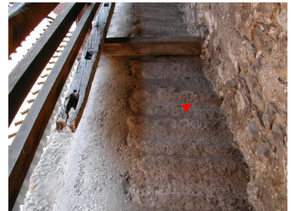
COURTINE NORD Détail des dalles à rigole attestant la disposition d'origine (1277-1280) du chemin de ronde à ciel ouvert; les grandes dalles situées au-dessus ont disparu
