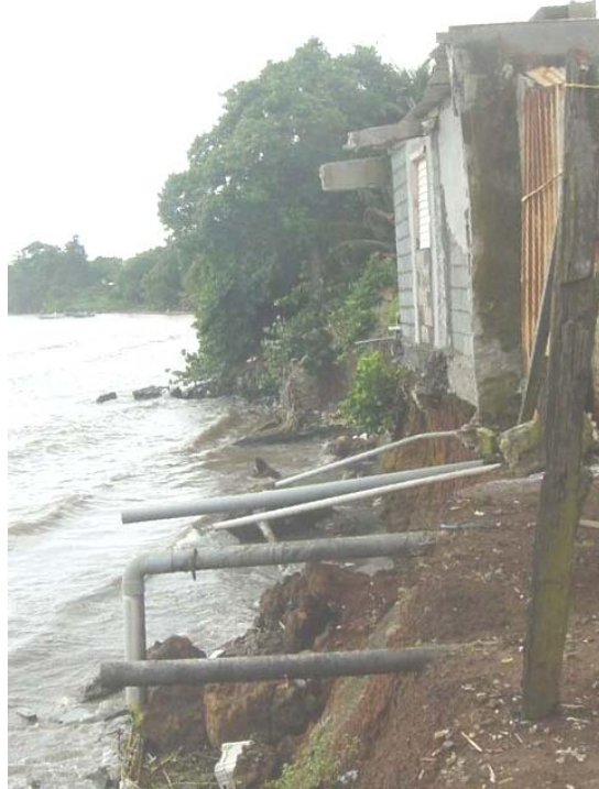
Figure 158 – Capesterre : maison en bordure de la falaise côtière effondrée.
