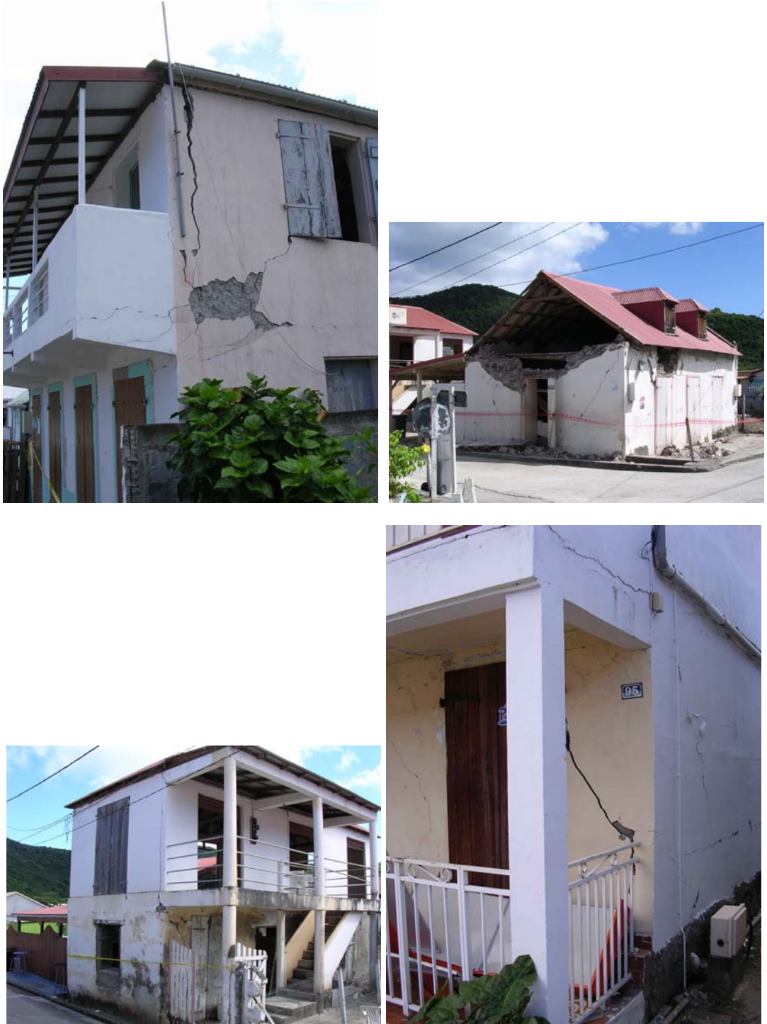
Figure 62 - Terre de Bas : dommages à plusieurs maisons individuelles.
