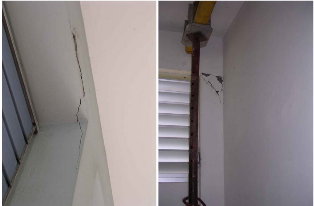
Figure 64 - Grand Bourg : fissure légère sur la structure de l'école du bourg (à gauche) et sur un poteau d'un bâtiment du lycée (à droite).
