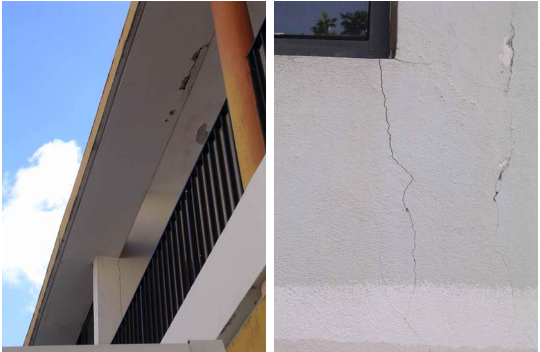
Figure 86 - Sainte-Rose : dommages légers sur un bâtiment rajouté de la mairie. L'extension à été réalisée en 1972.
