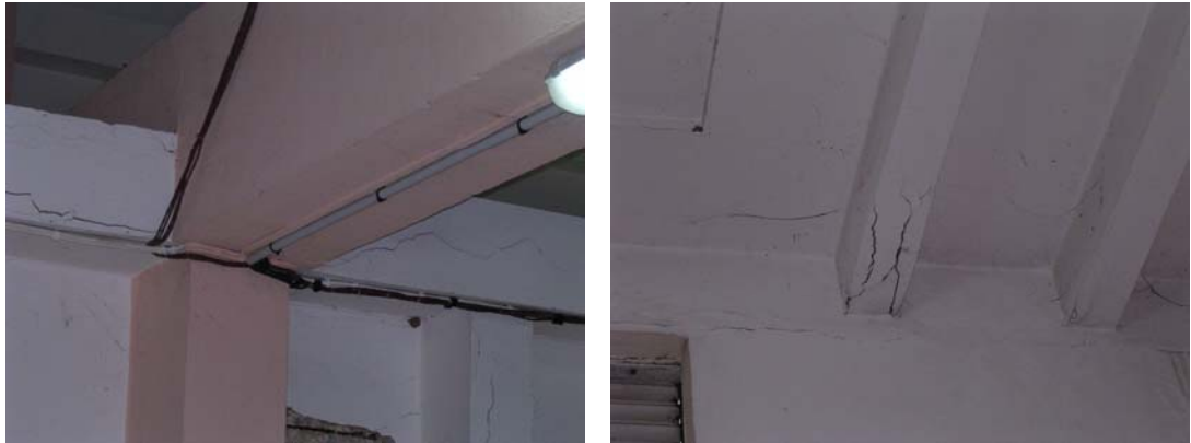
Figure 101 - Église : fissures dans la structure porteuse.
