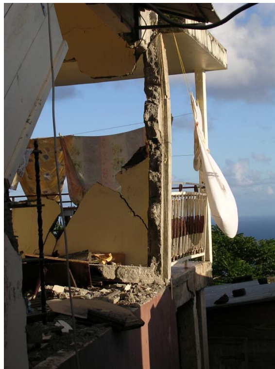
Figure 12 - La Plaine-Trois Rivières : effondrement partiel d'une maison.
