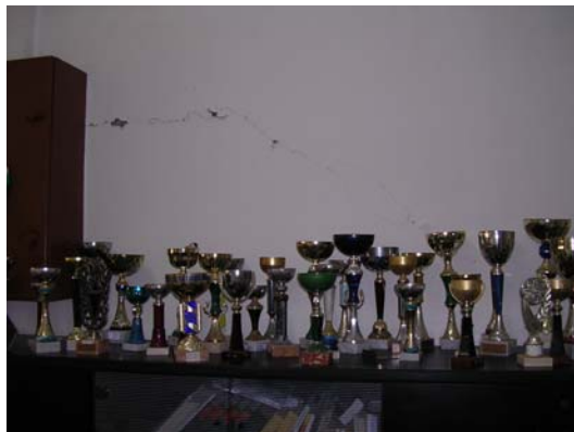
Figure 97 - École mixte II : fissure sur un mur non porteur. Sur toutes les coupes, seules 3-4 ont été renversées par le séisme.
