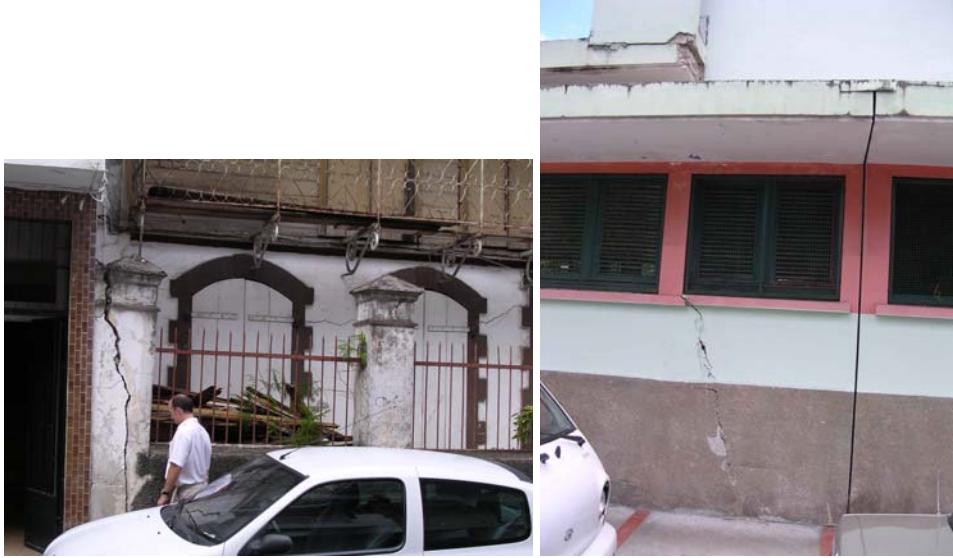
Figure 103 - Centre ville : dommage à une maison individuelle ancienne (gauche) et à l'école Fengarol.
