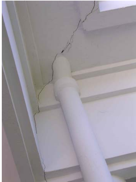
Figure 71 - Trois Rivières : exemple de dommage à la mairie.
