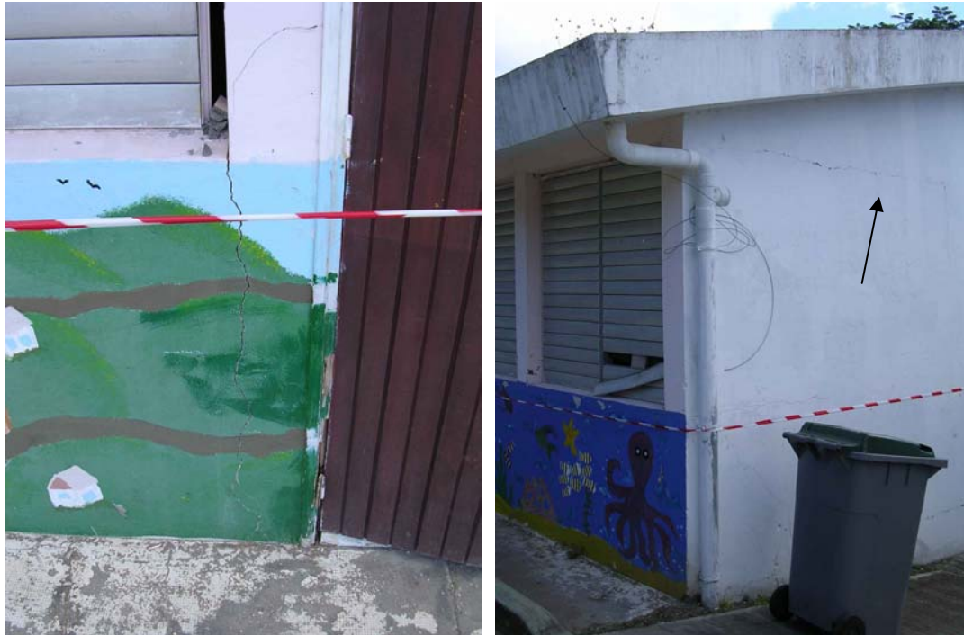
Figure 56 - Terre de Bas : dommages sur la structure à l'école maternelle.
