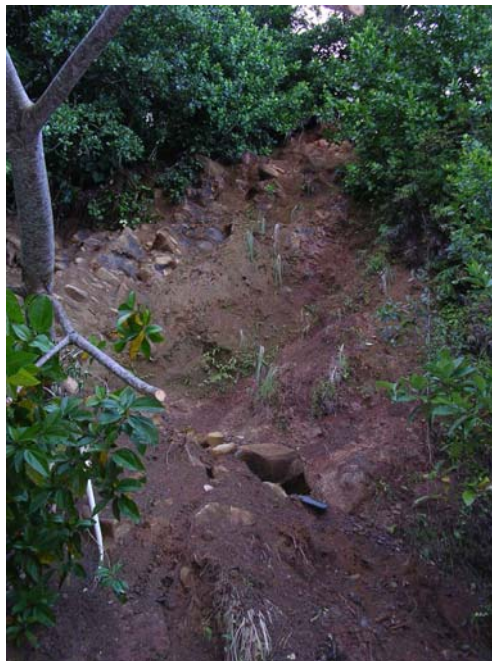
Figure 95 - Glissement de terrain consécutif aux pluies et au séisme et menaçant une route d'accès à des habitations isolées.
