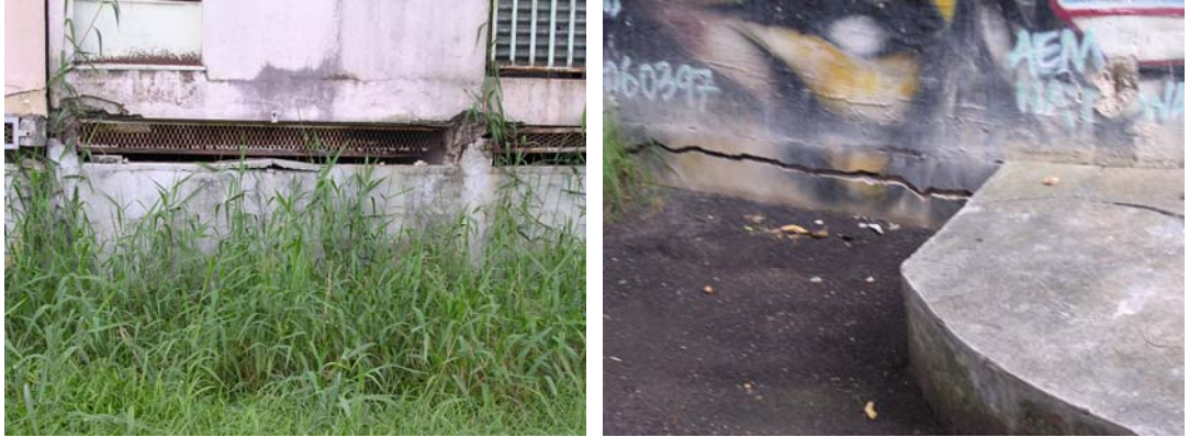
Figure 105 - Cité Henri IV : fissures sur les structures porteuses.
