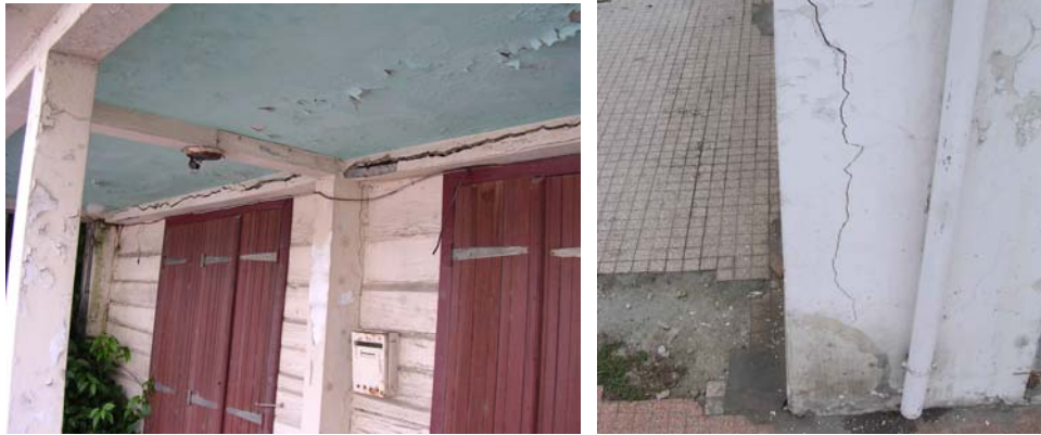
Figure 66 - Grand Bourg : fissures légères sur les structures de deux maisons d'habitation.
