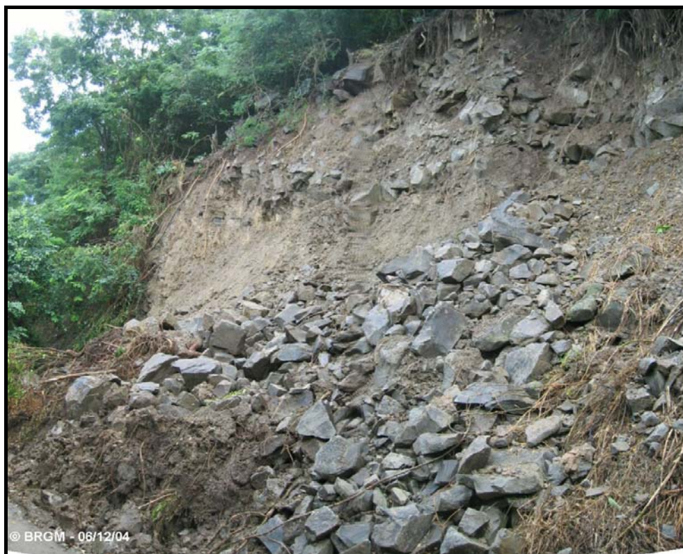
Figure 109 - RD 214 : partie orientale de l'éboulement de la route du Chameau.
