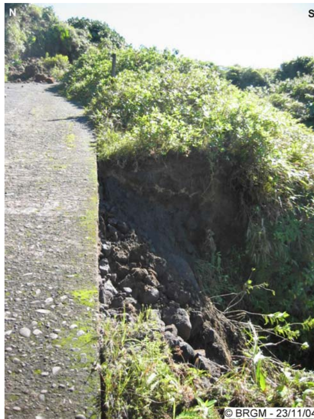
Figure 128 - RD11 en aval du glissement 3 : talus aval de la chaussée effondré.
