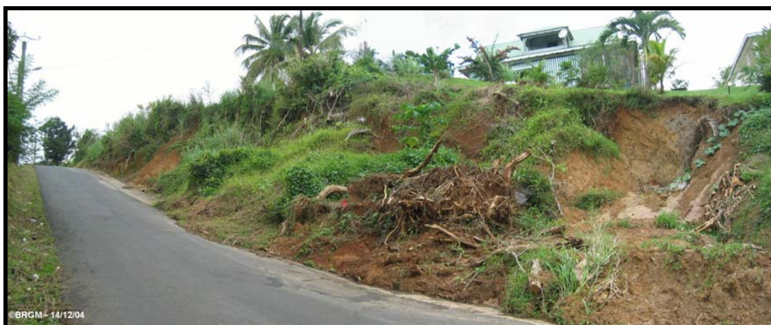
Figure 172 - Calvaire Chapelle : glissements sur le talus amont de la chaussée.
