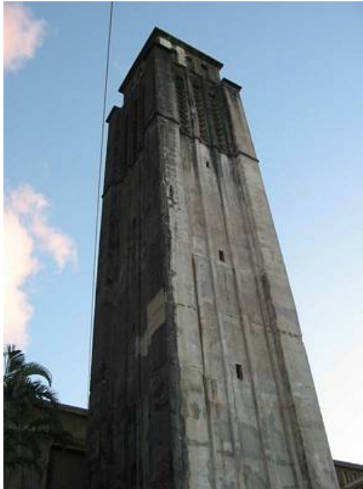
Figure 75 – Gourbeyre : dommages sur le clocher de l'église.
