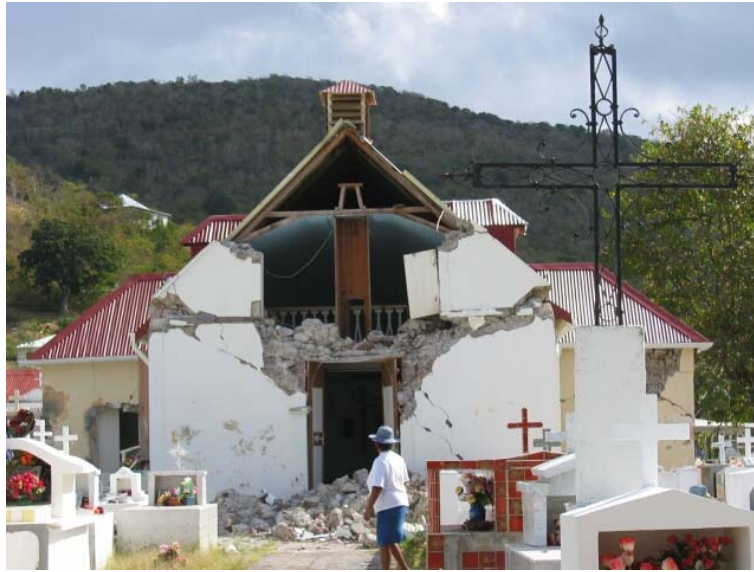
Figure 11 - Terre de Bas : église de Petites Anses après le séisme.
