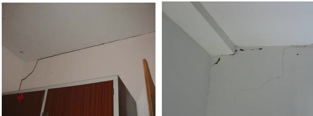
Figure 83 - Vieux Habitants : exemple de fissures constatées à l'école.
