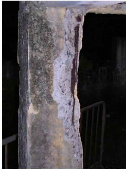
Figure 94 - Seul dommage qui nous a été montré sur la commune de Goyave.
