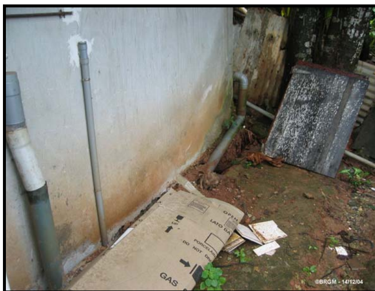
Figure 169 - Baie Mahault : affaissement de la terrasse de la maison de M. Henri et apparition des fondations.
