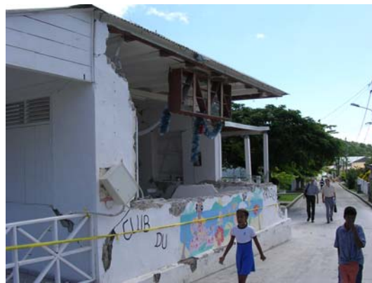
Bâtiment en maçonnerie brute, sans chaînage.
