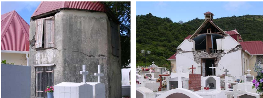
Figure 57 - Terre de Bas : dommages sur le clocher et le fronton de l'église.
