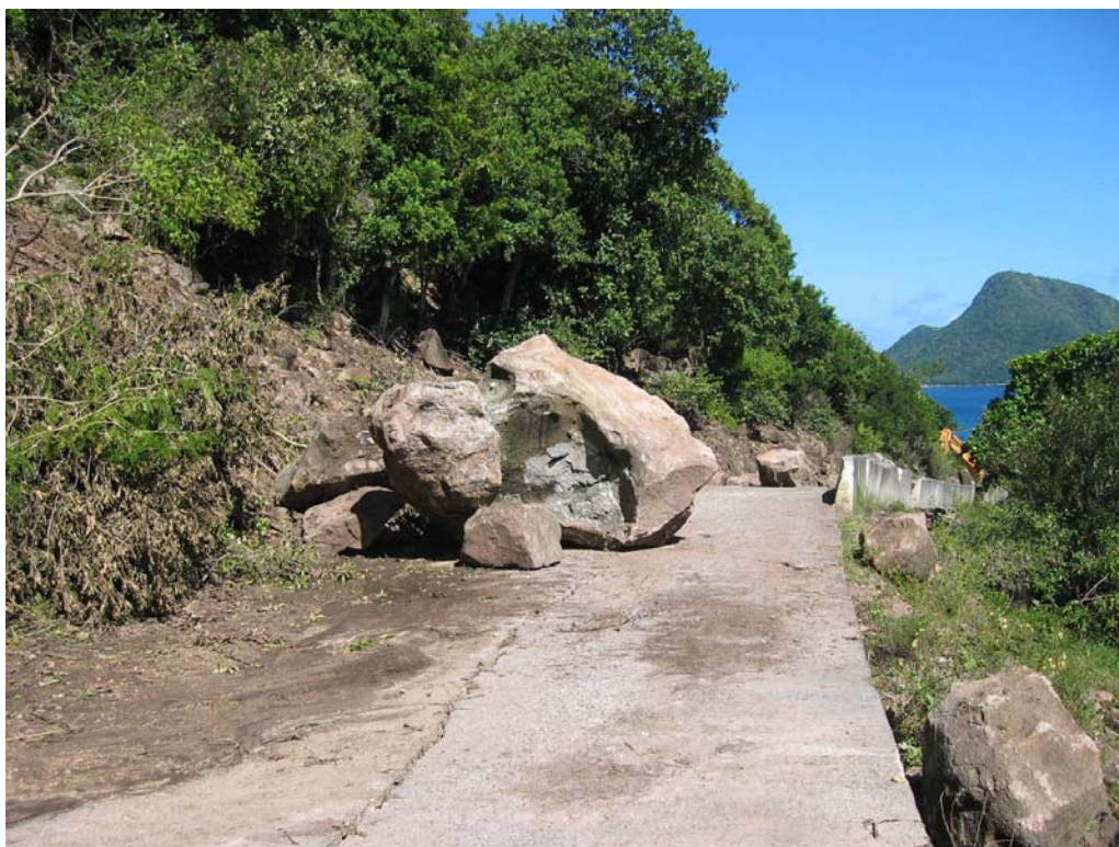
Figure 107 - RD 213 : éboulements sur la route.
