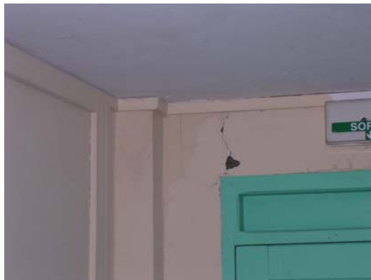
Figure 99 - École mixte II : fissure dans l'encadrement d'une porte de classe.
