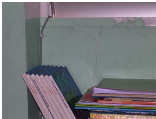
Figure 100 - École mixte II : fissure dans la structure non porteuse au niveau de la bibliothèque au premier étage.
