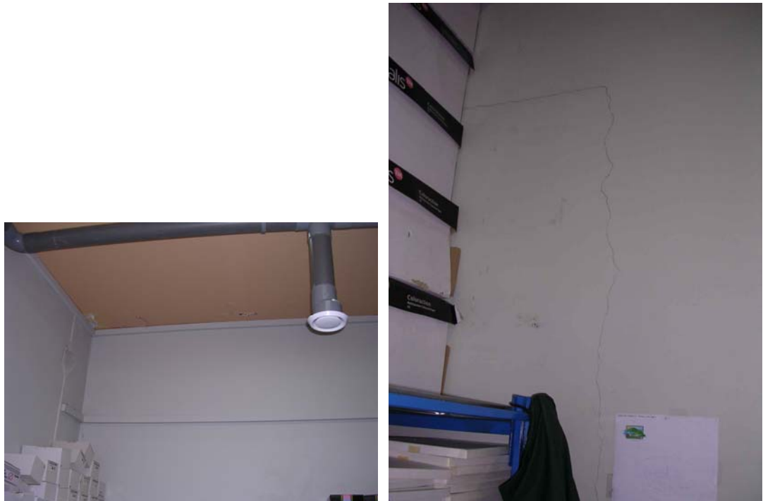
Figure 102 - Mairie : fissures légères dans la structure non porteuse. Salle de reprographie.
