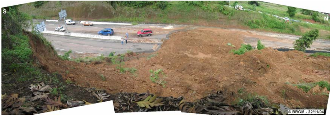
Figure 163 - RN1 : glissement vu du dessus (propriété M. Romain).
