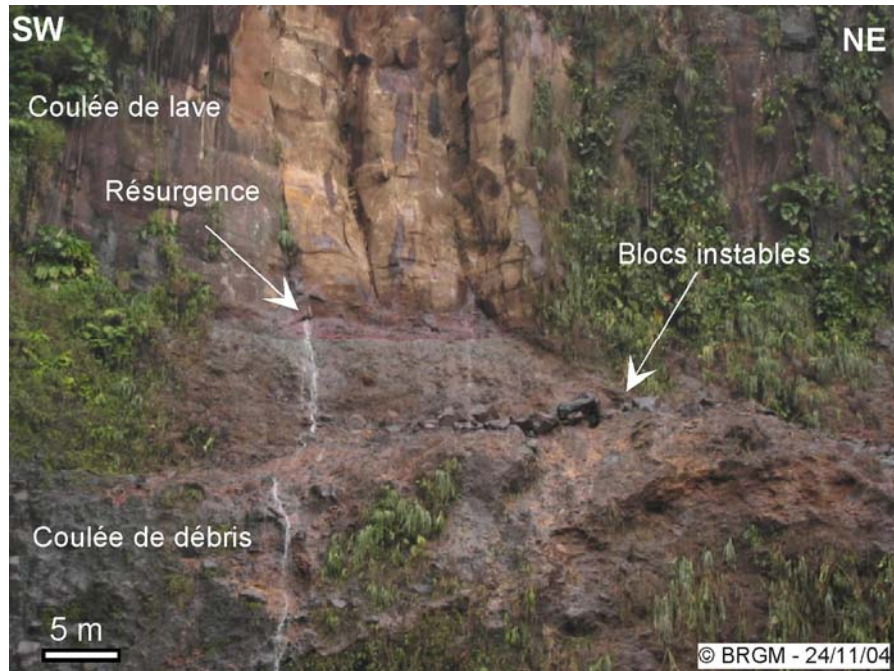
Figure 155 - Chutes du Carbet : blocs en instabilité 80 m au-dessus de la piscine naturelle et résurgence à l'interface entre les deux formations.
