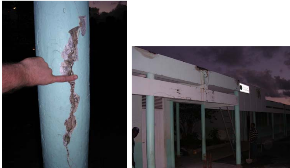
Figure 93 - École de Sainte-Marie : le poteau endommagé montré sur la photo de gauche est le poteau d'angle de la photo de droite.
