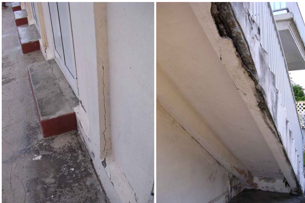
Figure 88 – Capesterre : dommages structuraux légers sur l'école de Bananier.
