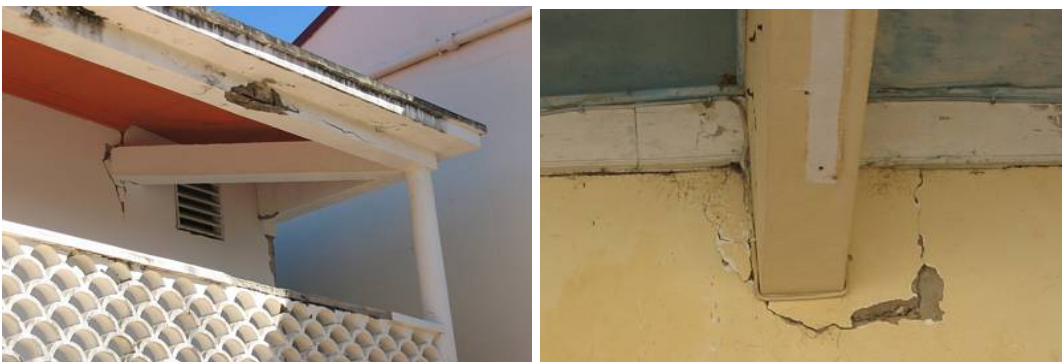
Figure 50 - Terre de Haut : exemple de dommages sur des maisons du Bourg.
