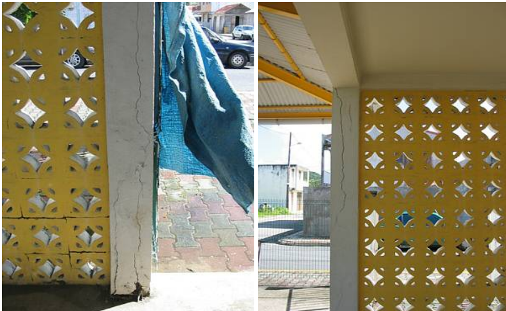
Figure 69 - Saint-Louis : fissures sur les poteaux du marché couvert.
