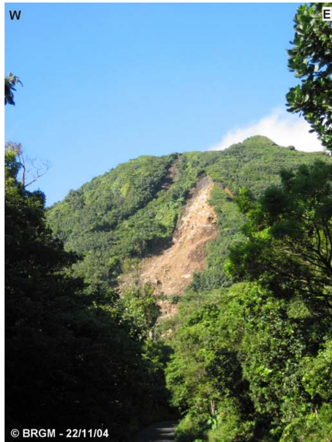
Figure 120 - RD11 : glissement 1 vu de la route en contrebas. On observe également sur la gauche la coulée qui part du piton Tarade et atteint la route au-dessus du lacet.
