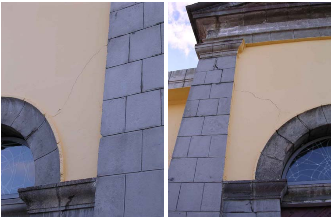
Figure 90 – Capesterre : fissures « symétriques » sur l'église du bourg.
