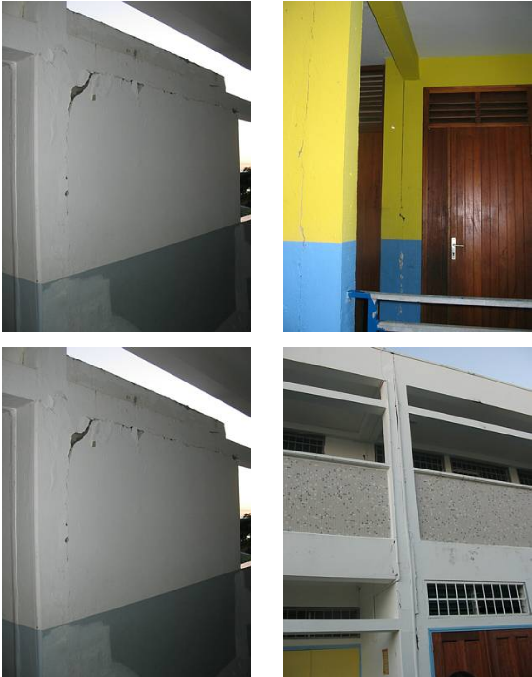
Figure 84 – Bouillante : exemple de dégâts légers sur des écoles.
