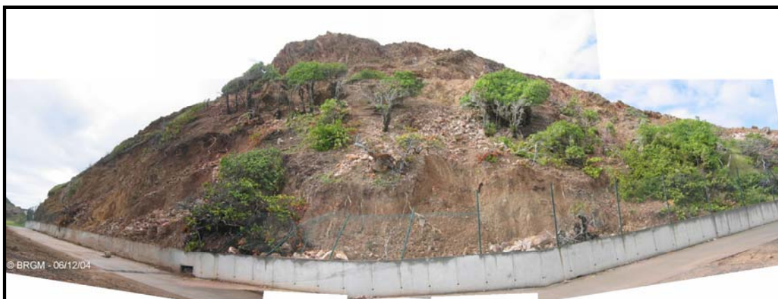
Figure 115 - Photo 3 : glissements de terrain et éboulements sur la route de Grande Anse.
