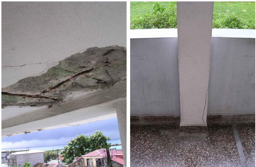
Figure 65 - Grand Bourg : éclatement du béton et fissure légère sur la structure de la mairie.
