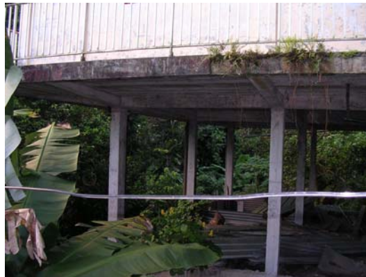
Figure 72 - Trois Rivières : maison très vulnérable n'ayant subi aucun dommage. Lieu dit « Soldat ».
