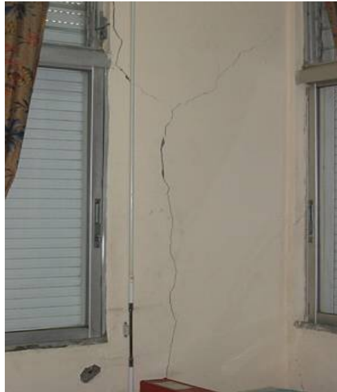
Figure 70 - Saint-Louis : fissures larges dans le bâtiment de la mairie.
