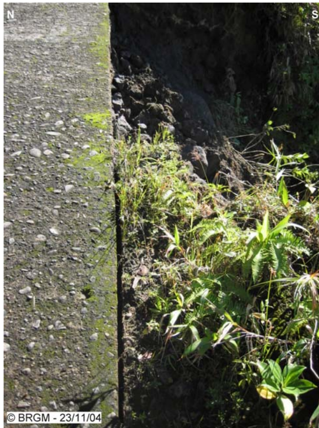
Figure 129 - RD11 en aval du glissement 3 : fissure de traction entre la chaussée et le talus.
