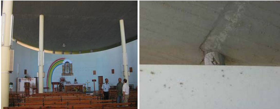
Figure 82 - Saint-Claude, église de Matouba : fissures sur les poteaux courts soutenant la dalle en béton du toit.
