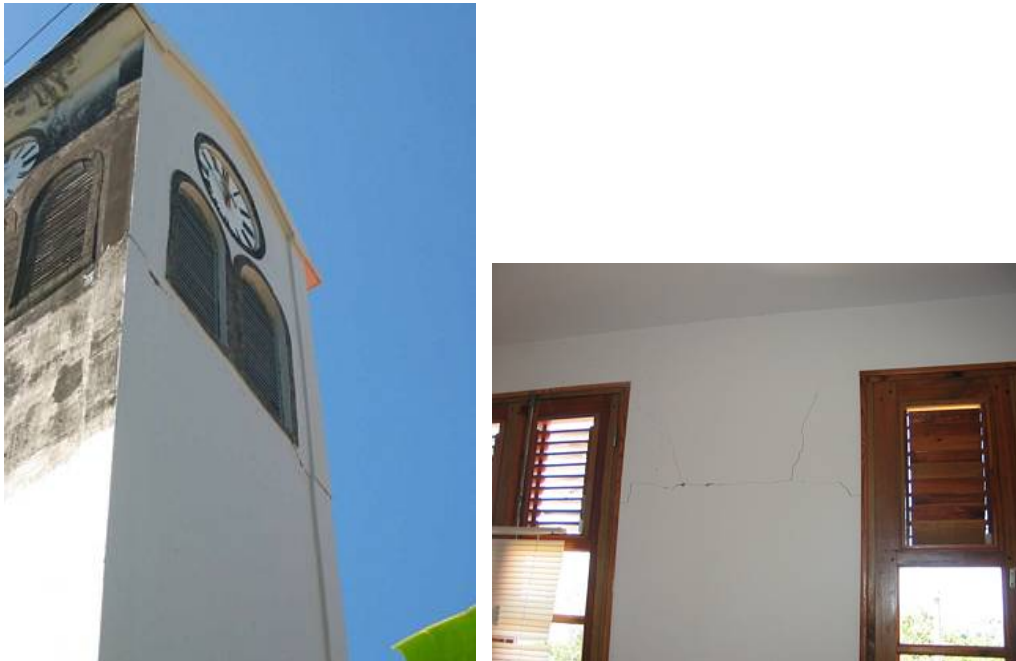
Figure 77 - Saint-Claude : fissures sur le clocher de l'église et dans les locaux de la police municipale face à l'église.
