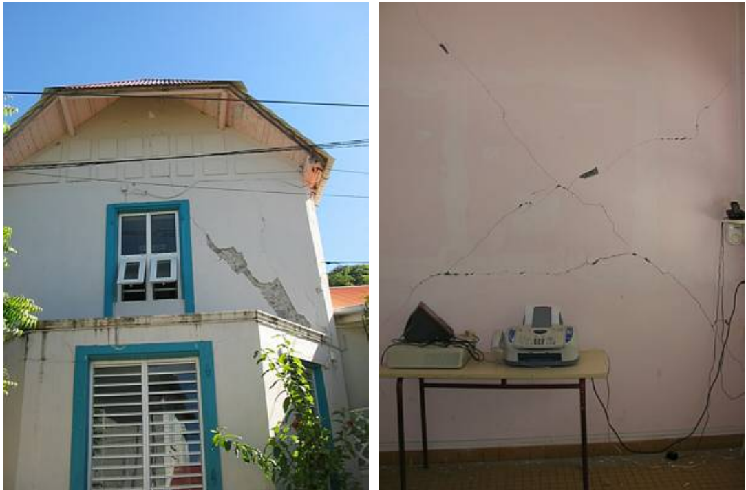
Figure 48 - Terre de Haut : dommages sur l'école communale du bourg.
