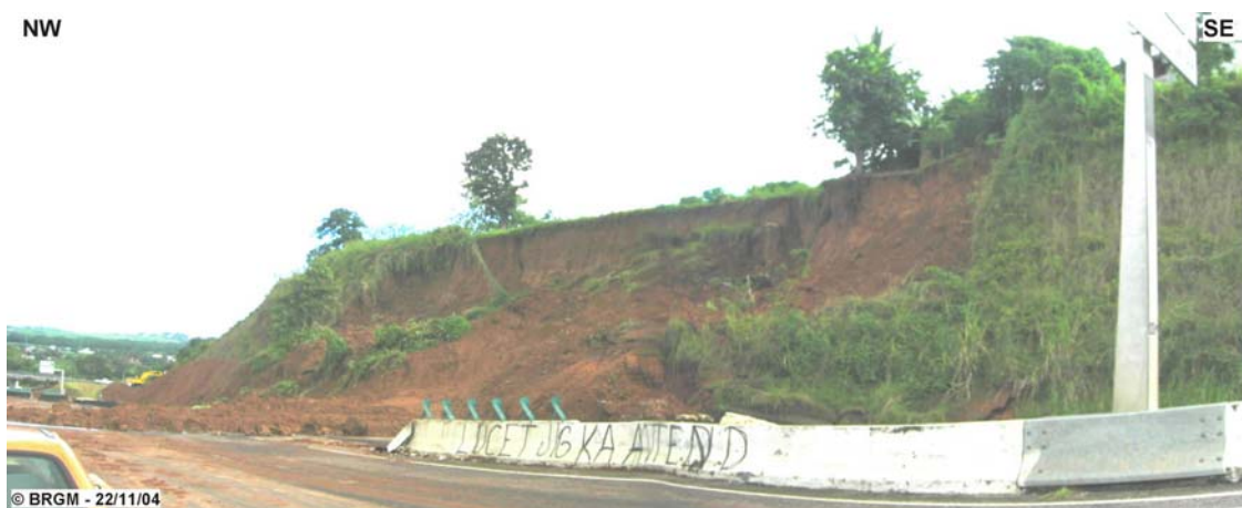
Figure 162 - RN1 : glissement vu depuis la chaussée.
