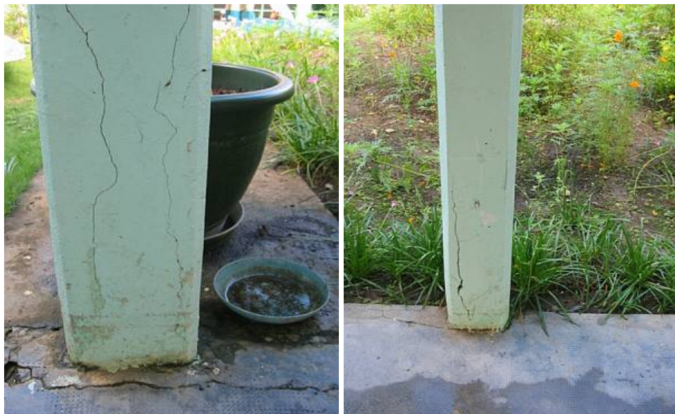
Figure 68 - Saint-Louis : fissures sur les poteaux de la cour de l'école maternelle.
