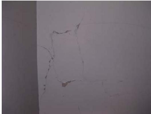
Figure 98 - École mixte II : fissure dans la cage d'escalier.
