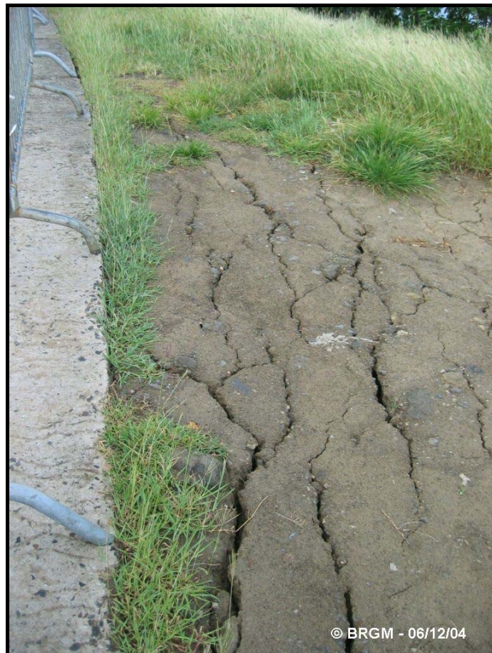
Figure 114 - Photo 2 : fentes d'extension dans le bas coté (talus aval).
