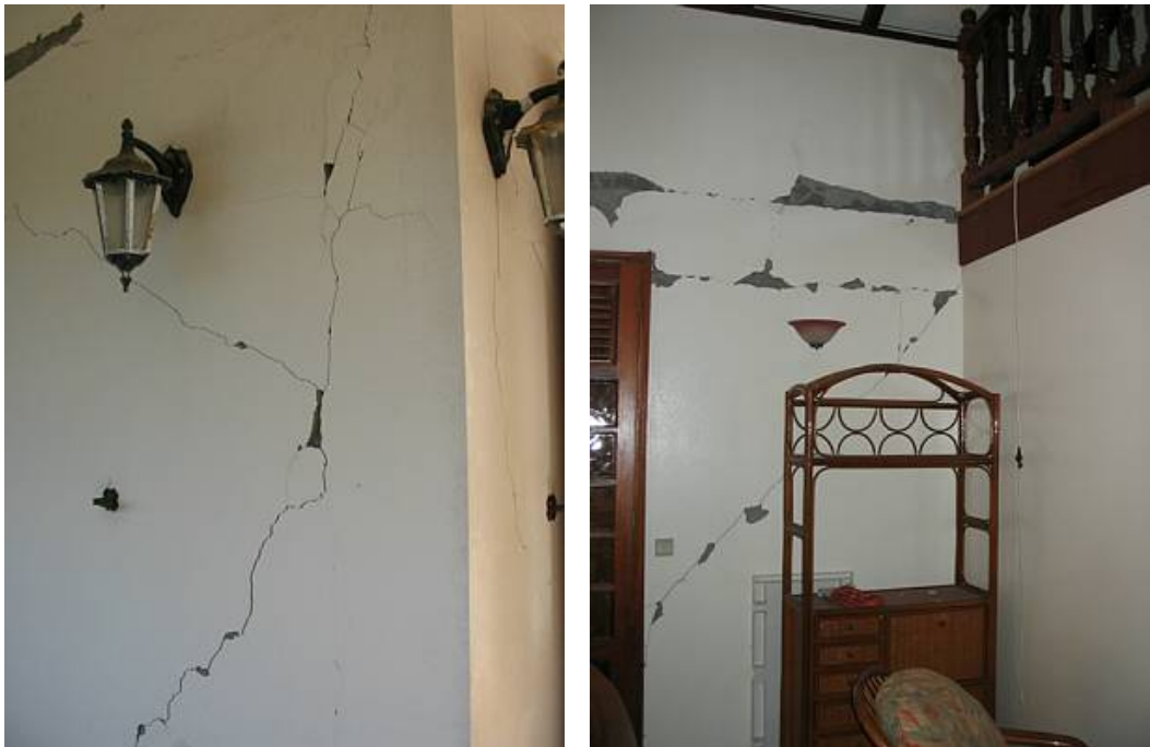
Figure 52 - Terre de Haut : dommages graves sur des maisons au-dessus du Pain de Sucre.
