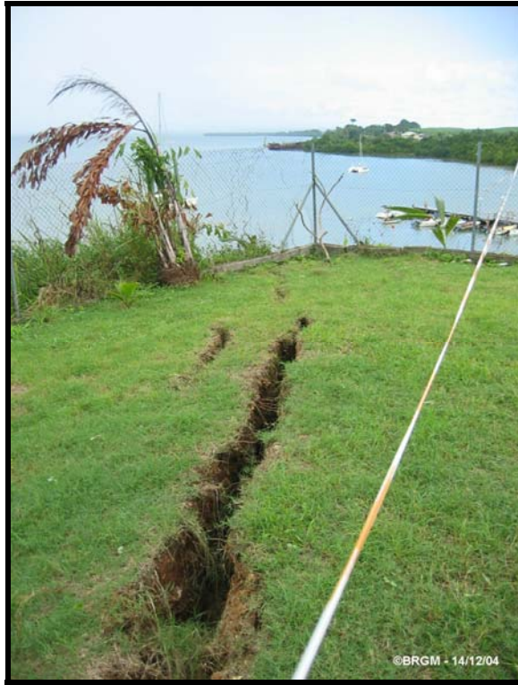
Figure 170 - Baie Mahault : glissement au sommet de la butte derrière le monument aux Morts.
