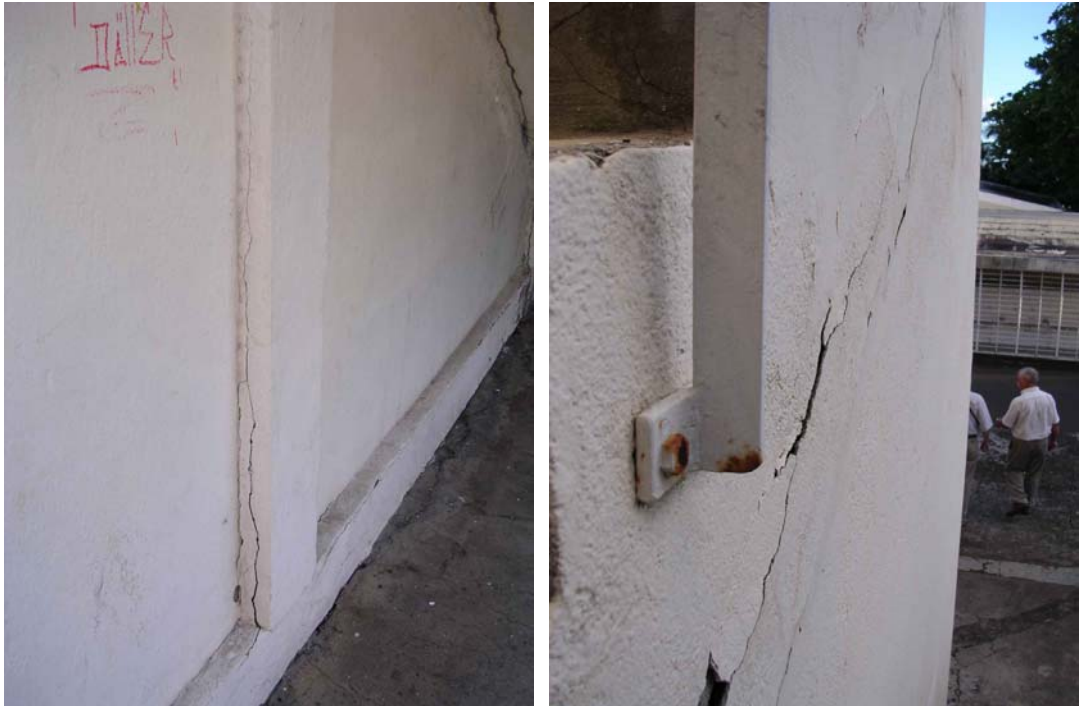
Figure 89 – Capesterre : dommages structuraux légers sur l'école de Bananier.
