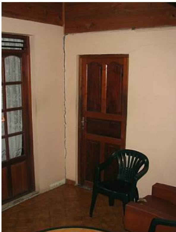
Figure 85 – Bouillante : fissure large sur une maison du lieu-dit Courbaril, liée plus probablement à un mouvement de terrain.
