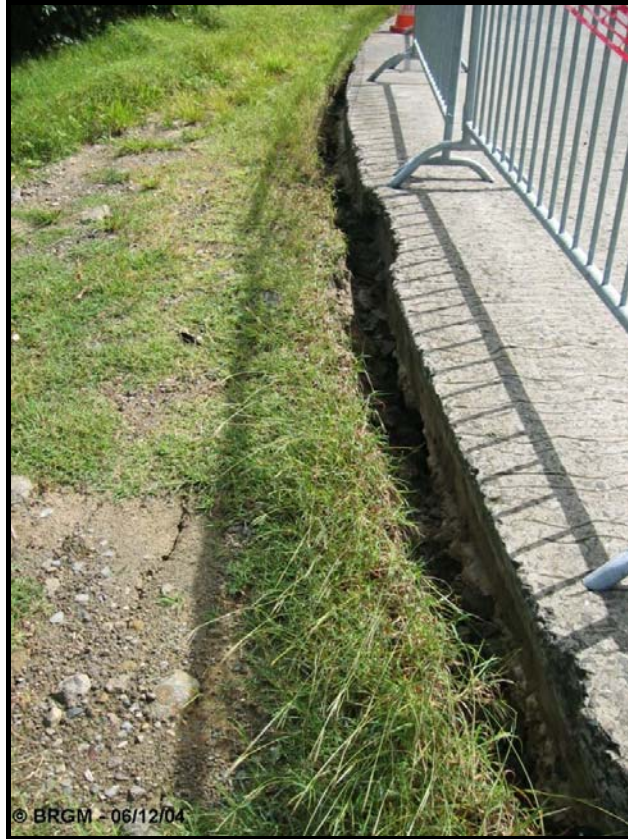
Figure 113 - Photo 1 : affaissement du talus aval par rapport à la chaussée.
