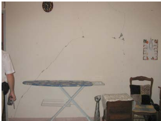
Figure 76 – Gourbeyre : fissures en croix sur une cloison d'une maison de Dolé.
