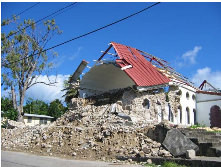
Figure 13 - Portsmouth, Dominique : effondrement partiel de l'église catholique.
