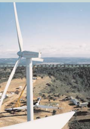
Parc éolien de Néviaan (Aude) La Compagnie du Vent©
