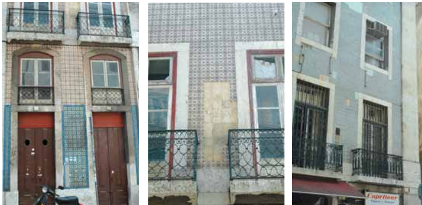
Fig. 26 – Paramentos revestidos a azulejo de recuperação discutível.
