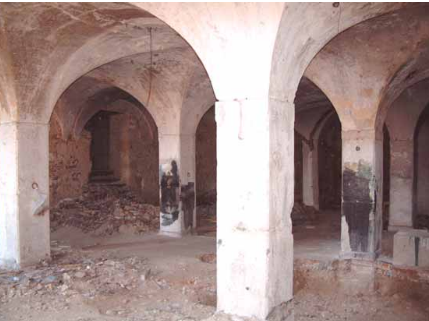
Fig. 4 – Sistema de suporte com pilares e abóbadas de tijolo a cutelo, Rua Ivens.
