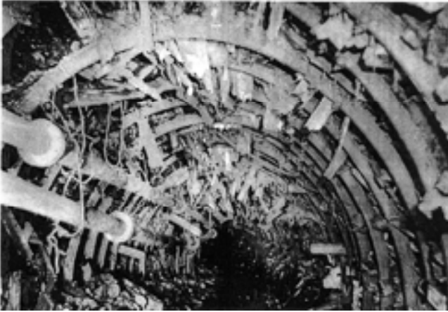
Рис. 6.10. Видгляд зруйнованих дерев'яних з'язяжок при задовільному стані рам кріплення
