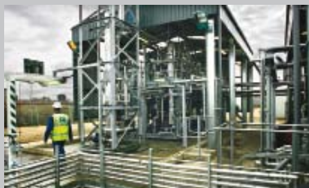
D1 30 biodiesel refinery
