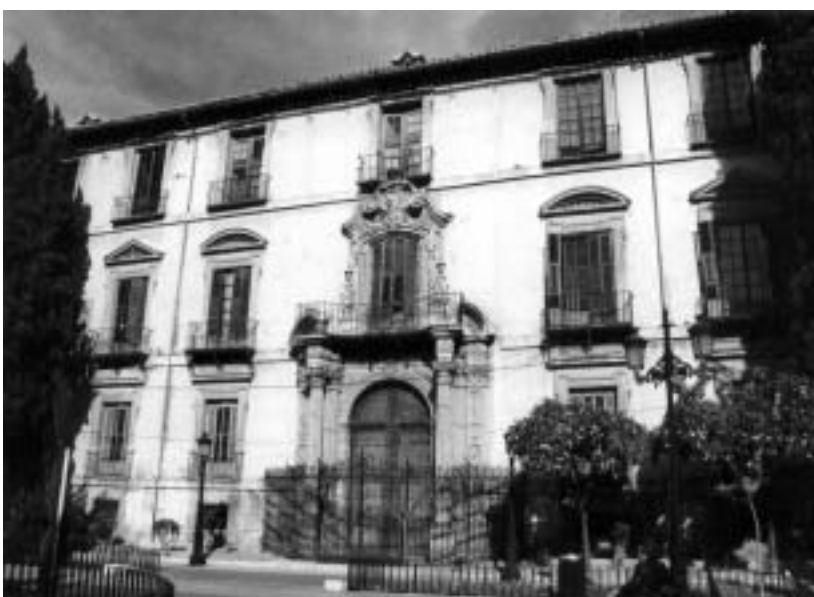
Estado inicial de la fachada sur. El deterioro de las carpinterías las hacía irrecuperables. El mal estado de las bajantes favorecía la aparición de biodeterioro y en la portada, las reintegraciones con mortero de cemento de intervenciones anteriores estaban acelerando el deterioro de este elemento.
