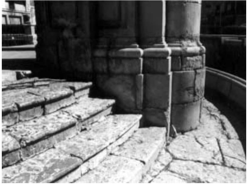
Estado inicial del deambulatorio, escalinata y basa de mármol.
