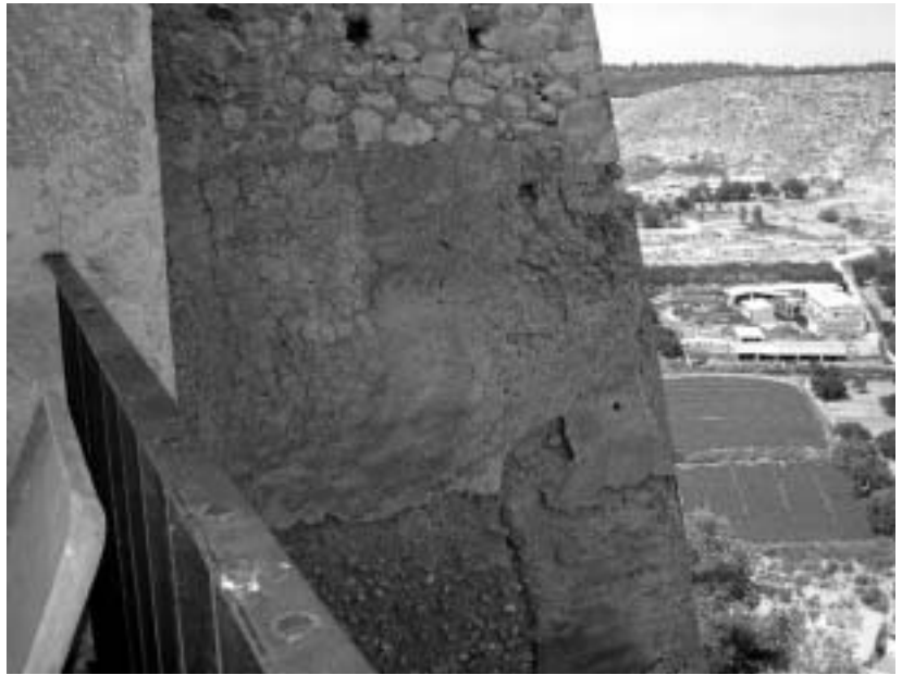
Detalle de una zona de la Torre Chacona antes de la intervención. Se distinguen la zona superior de mampostería y el resto de muro de tapia.
