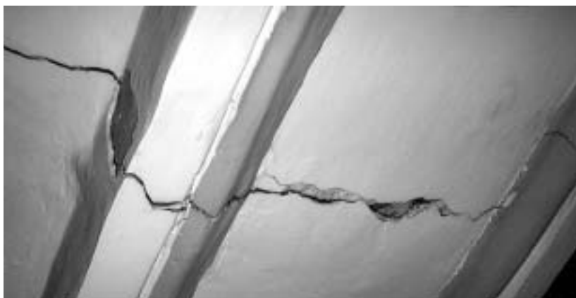
Grieta en un arco fajón de la nave principal.
