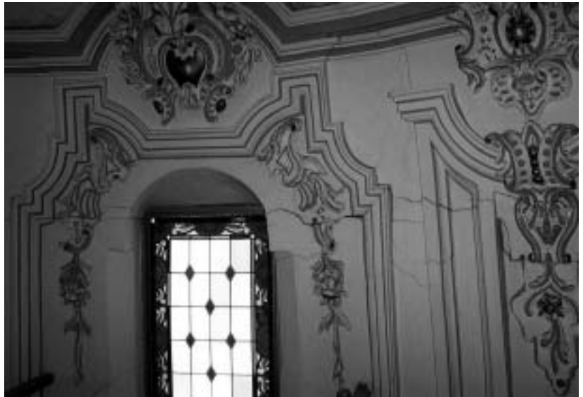
Grietas horizontales en el tambor de la cúpula del crucero, desde el interior.
