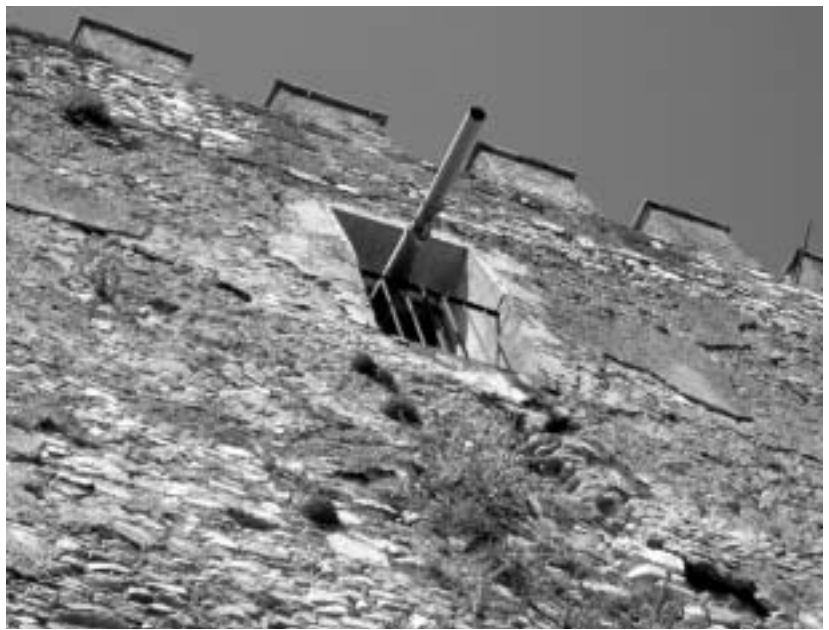
Estado previo a la restauración, con presencia de vegetación, desconchados, pérdidas de revestimiento y una salida de la red de saneamiento a través del balcón.
