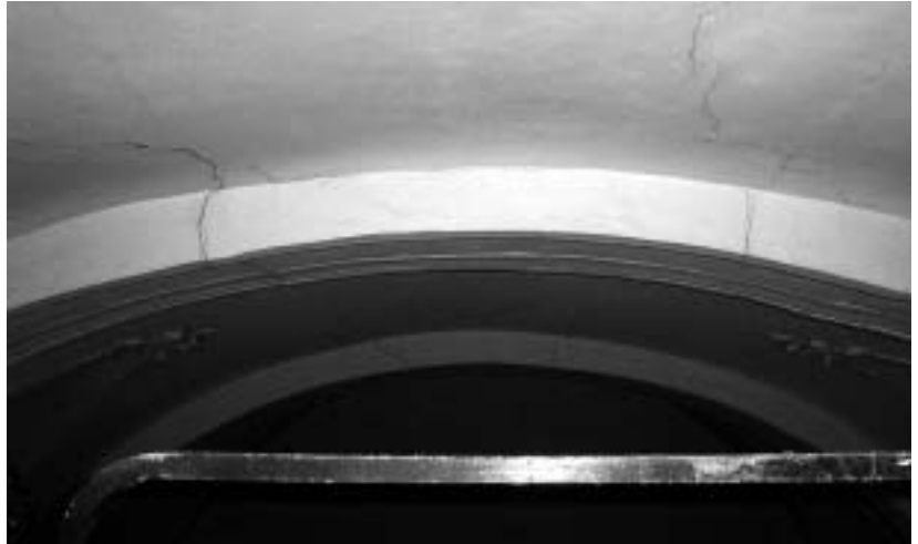
Múltiples fracturas en la bóveda de la nave principal.
