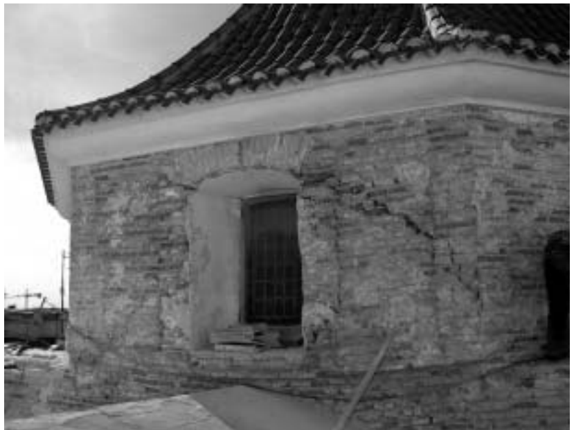
Grietas en el tambor de la cúpula del crucero, por encima de los tejadillos de las pechinas, una vez picados los revestimientos superficiales.
