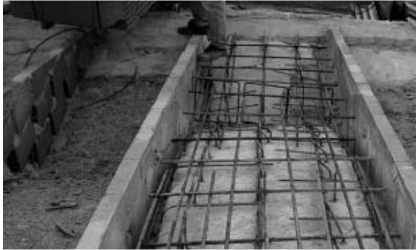
Refuerzo de uno de los arcos con viga de hormigón armado superior y anclajes de acero.
