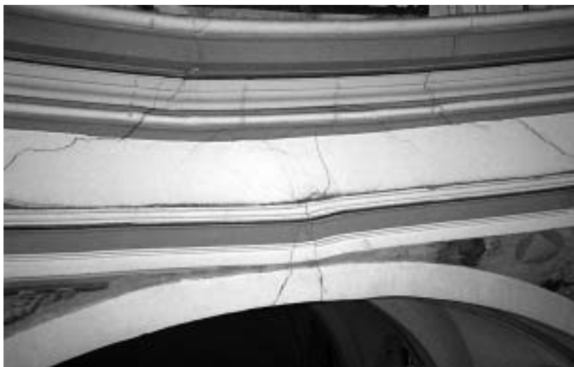
Detalle de grietas en el arco del crucero hacia la nave principal. Al encontrarse suelta la clave del arco, se ordenó el refuerzo inmediato.
