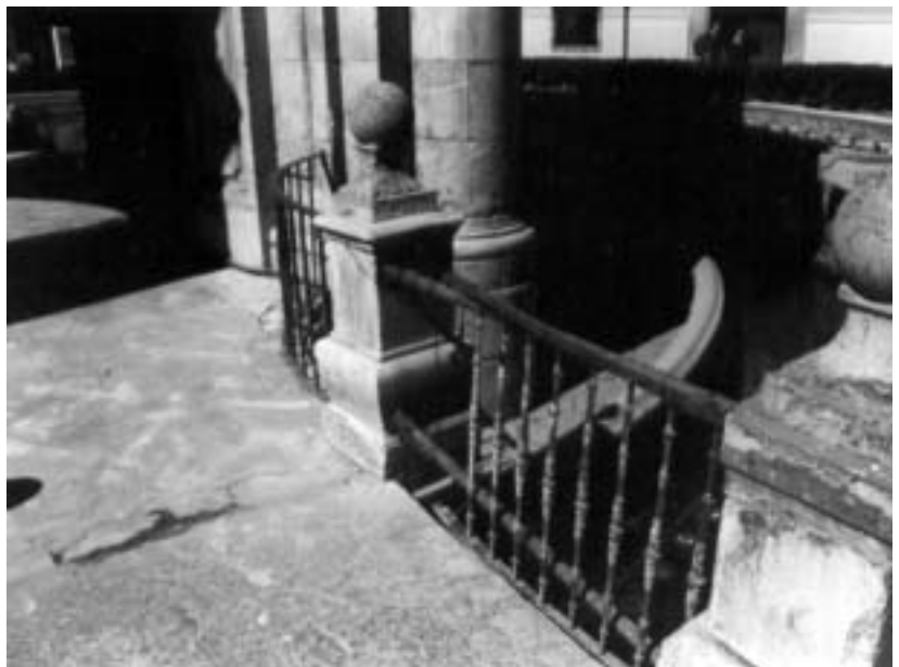
Detalle del estado previo a la intervención de la pasarela de acceso, con las pilastras deterioradas y la reja "colocada" a modo de barandilla.
