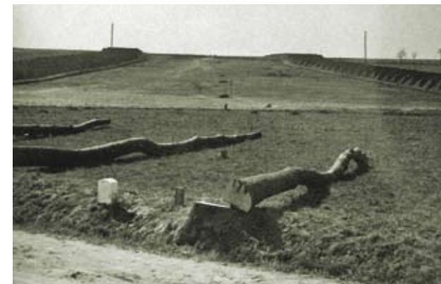
Od 11. 4. 1939 budují Němci další, tzv. průchozí dálnici přes naše území. Již v průběhu dubna se v terénu projevuje stavební činnost (Jevíčko 14. 4. 1939).
