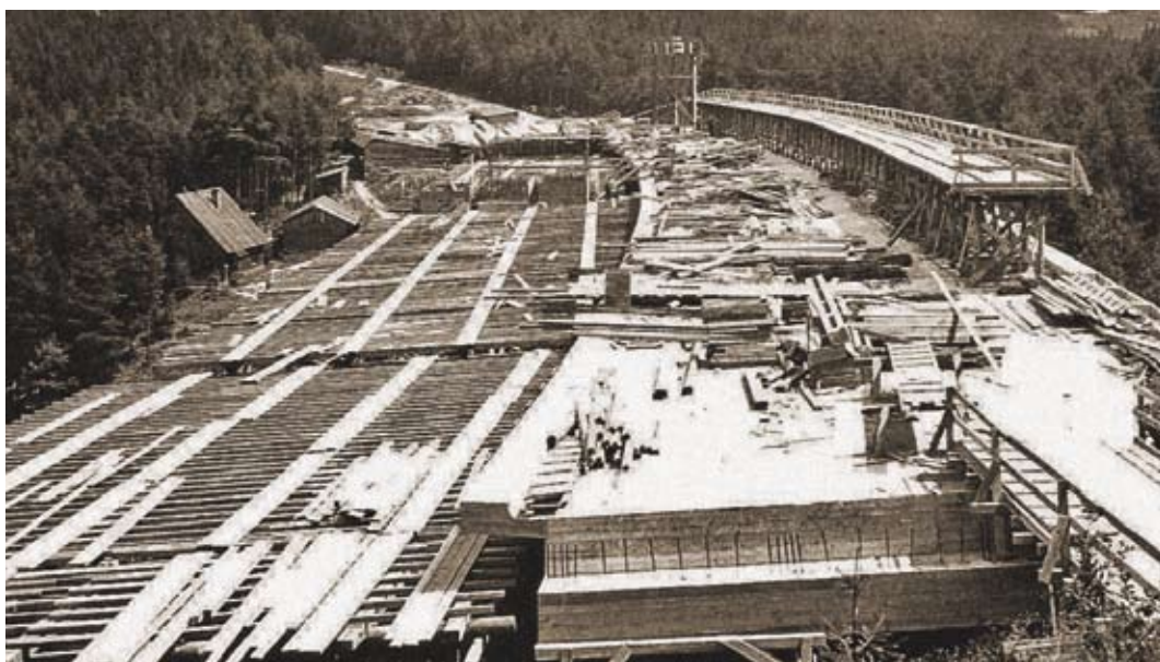
Stavba dálničního mostu přes Želivku u Píště pokračovala i v letech 1947 a 1948. Construction of the motorway bridge across the Želivka River valley by Píšť continued in 1947 and 1948.
