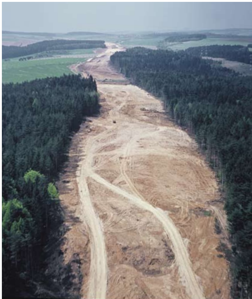
Po otevření prvního moravského úseku Brno–Kývalka dne 6. září 1972 pokračují práce na dálnici směrem k Velké Bíteši. After the opening of the first Moravian section, Brno – Kývalka, on 6 September 1972 work on the motorway continues in the direction of Velká Bíteš.
