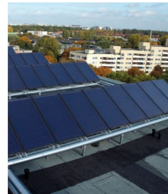
Solarthermieanlage auf dem Dach eines Mehrfamilienhauses.
