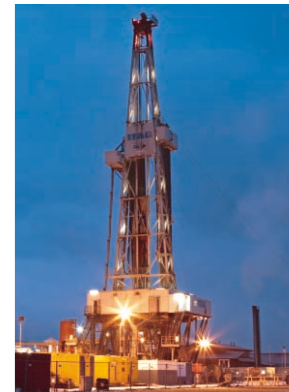
Wärme aus der Tiefe holen: Bohrung für ein geothermisches Kraftwerk in Sauerlach.
