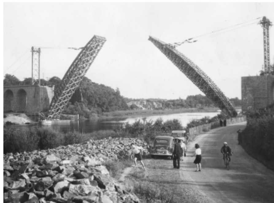
Pont de la Jonelière. Pour rétablir son tablier central, suite à sa destruction du 11 août 1944, deux demi-cintres sont mis en place en juillet 1947. Le pont est inauguré le 3 août 1948 (album 194)
