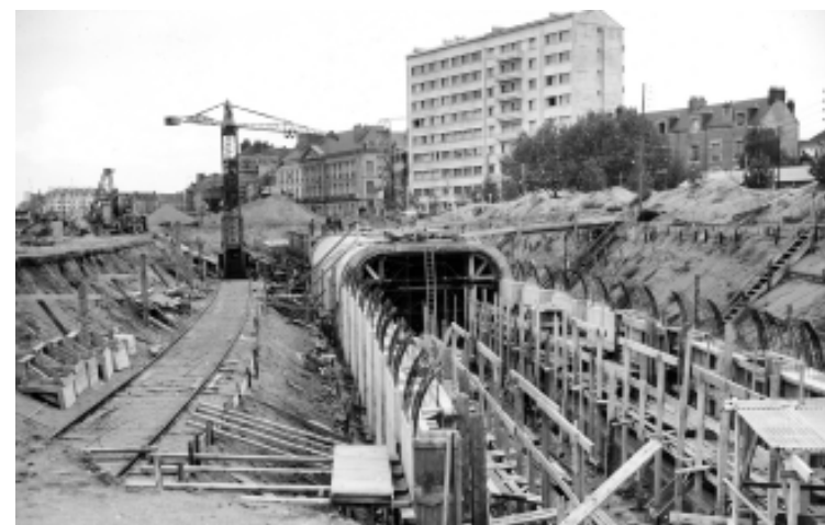
Tunnel ferroviaire sous l'Ile Gloriette. Déclarés d'utilité publique en 1934, les travaux de déplacement de la ligne de Chemin de fer Nantes-St Nazaire sont achevés en 1955 (24Fi3770)
