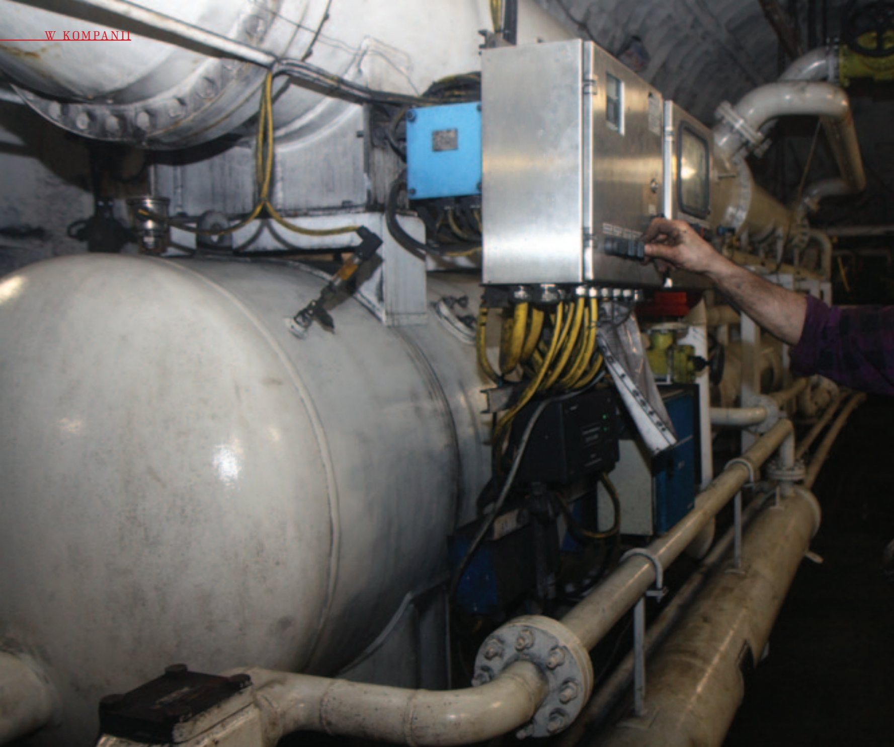
Stacja klimatyzacji na poziomie 1 000 m w KWK „Bielszowice”. Mariusz Wybieralski sprawdza parametry chłodzenia
