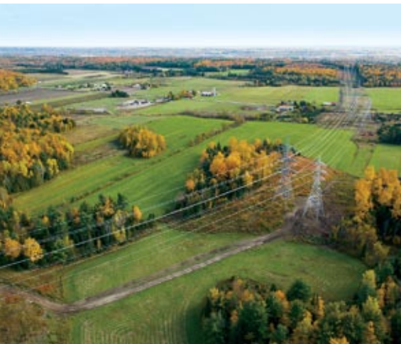
La ligne à 230 kV qui servira aux échanges d'énergie avec l'Ontario.
