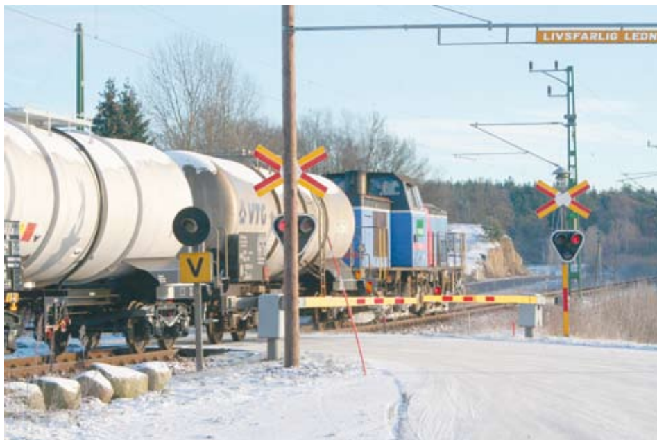
Ovan: Godstrafiken har gått på banan under hela ombyggnadstiden. Foto: Ingemar Elofsson
